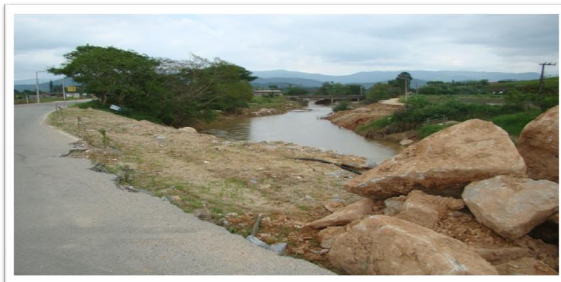
Figura 9: SC 408 Danificada pela Chuva (dezembro de 2008).
