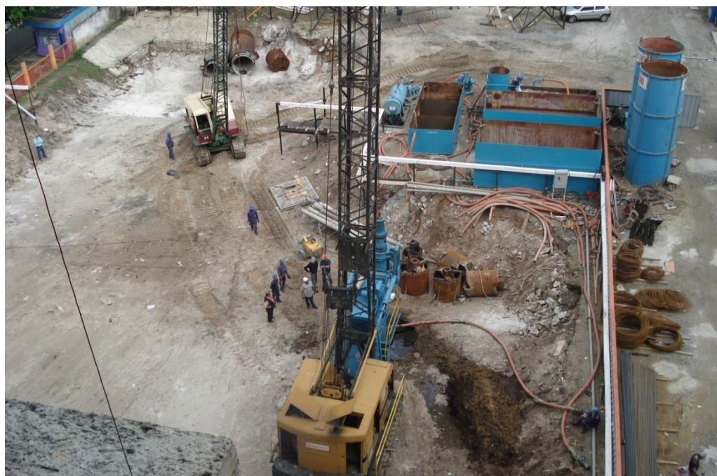
Fotografia 7 - Visão aérea da obra: Central de polímeros e Guindaste 38B em operação
