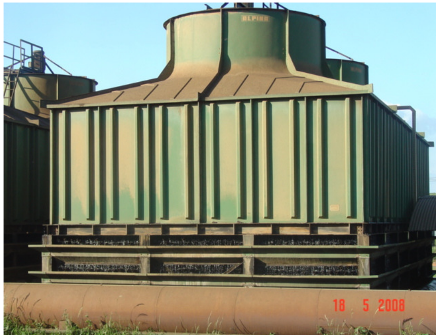
Figura 2.11. Foto de Uma Torre de Resfriamento da V.O.- Unidade Catanduva.
