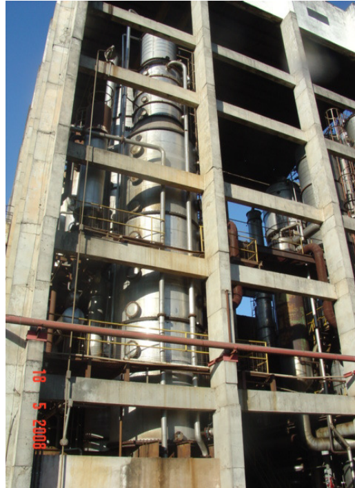
Figura 2.15. Foto de Uma Coluna de Destilação da V.O. - Unidade Catanduva.
