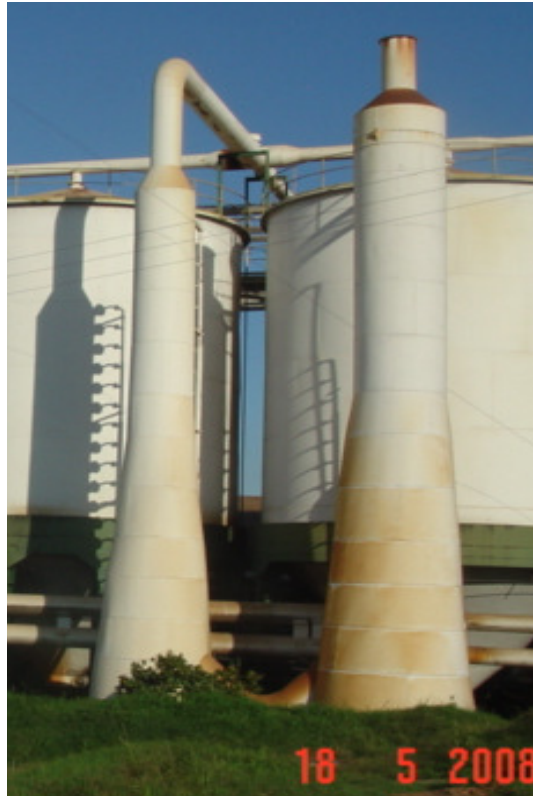
Figura 2.12. Foto da Torre de Lavagem de Dióxido de Carbono da V.O. – Unidade Catanduva.
