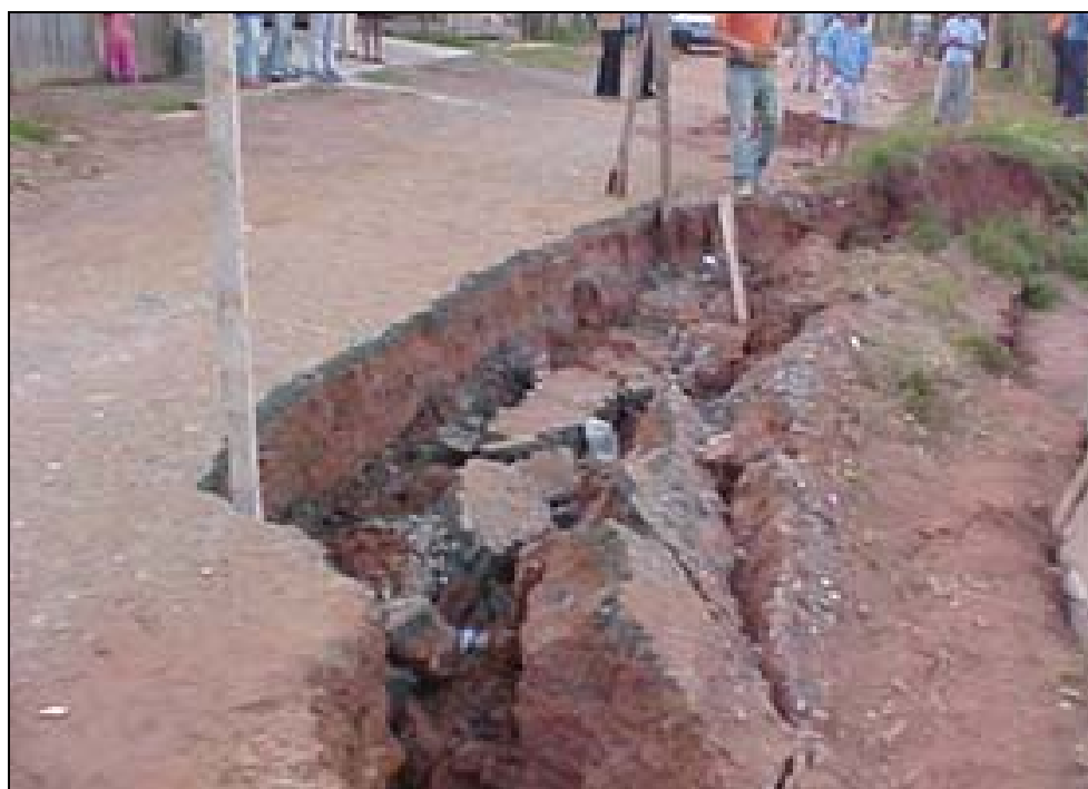
Fotografia 9 - Escorregamento em via pública. Fonte: SABESP, 2005.
