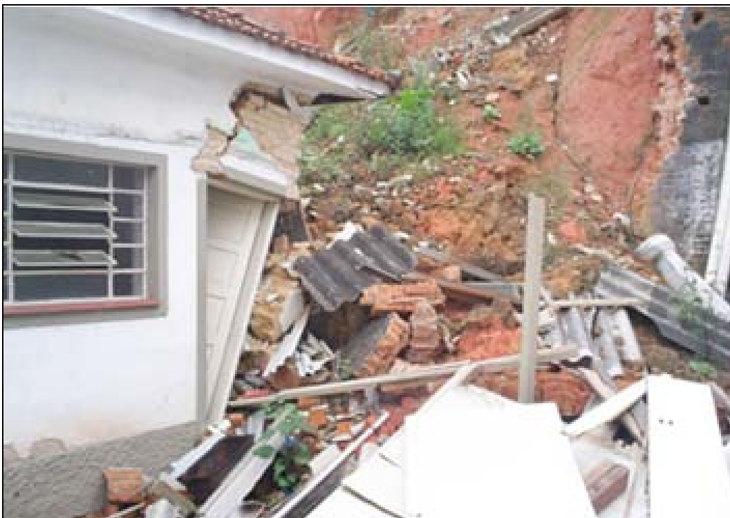
Fotografia 7 - Vista da edificação a jusante, atingida pelos materiais da erosão e dos escombros.
