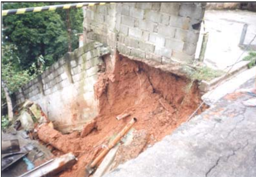
Fotografia 4: Desmoronamento da construção. Fonte: SABESP, 2005.
