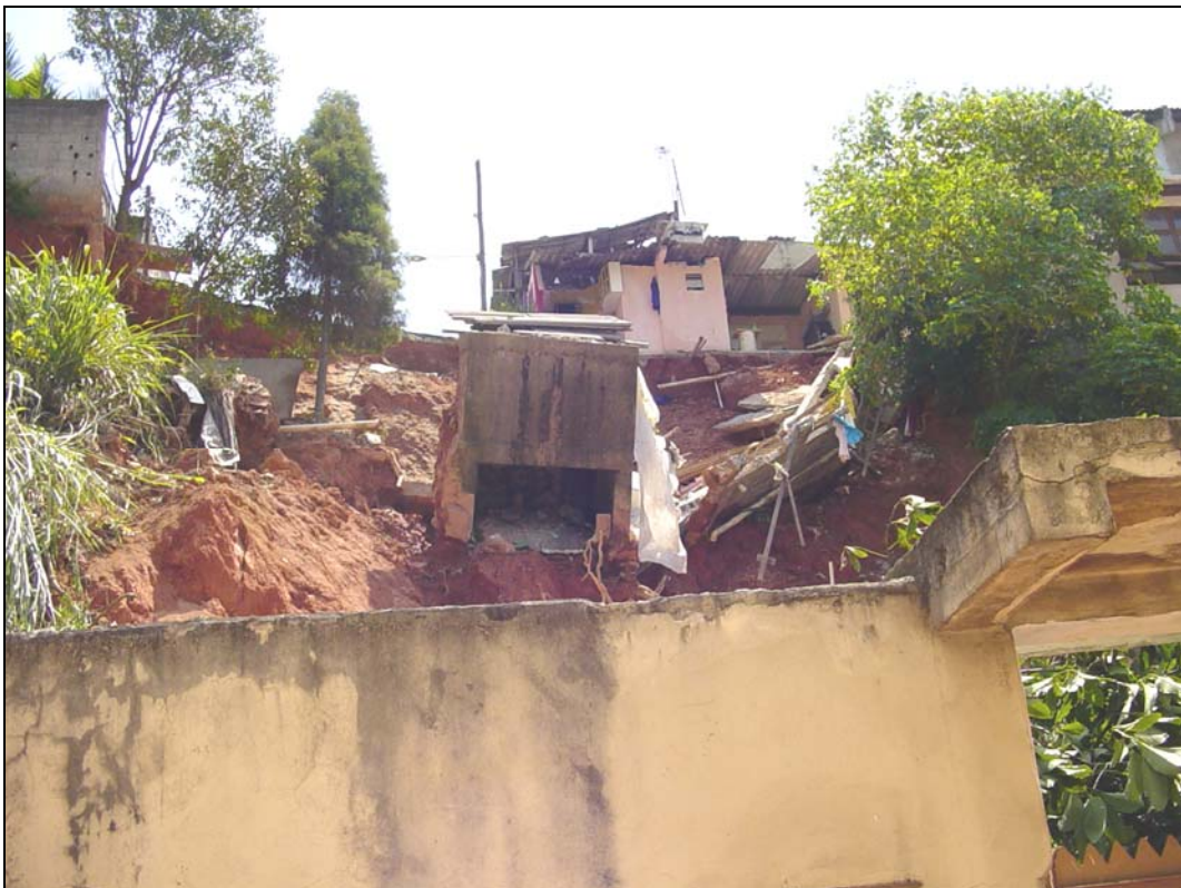
Fotografia 5 - Vista frontal do escorregamento. Fonte: SABESP, 2005.
