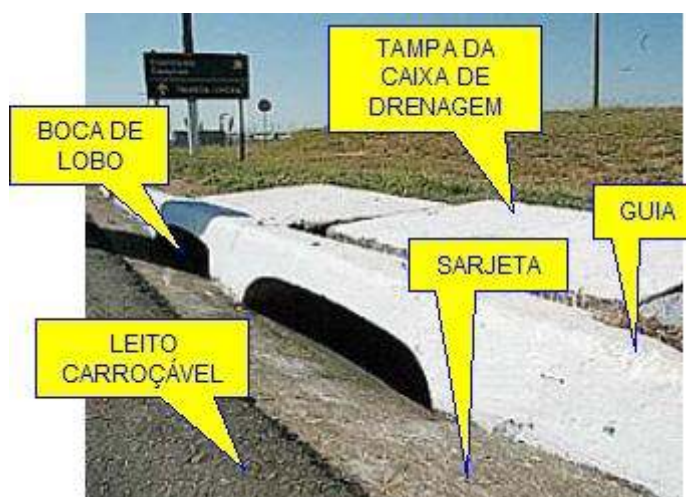
Figura 3.5: Sistema convencional de drenagem urbana e alguns de seus componentes. Fonte: Watanabe, s.d.
