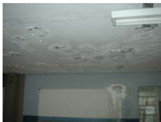
Figura 4.3:- Infiltração abaixo do local onde foi implantado o reservatório. Fonte: autora.
