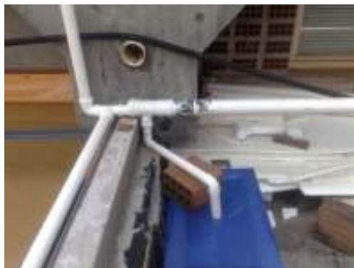
Figura 4.10: Conexões que controlam a entrada de água nos reservatórios Fonte: autora.
