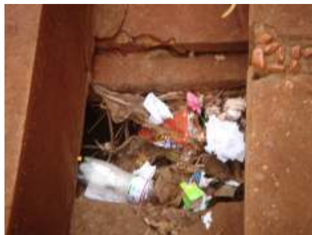
Figura 4.19: Uma das saídas das canaletas do estacionamento. Fonte: Autora
