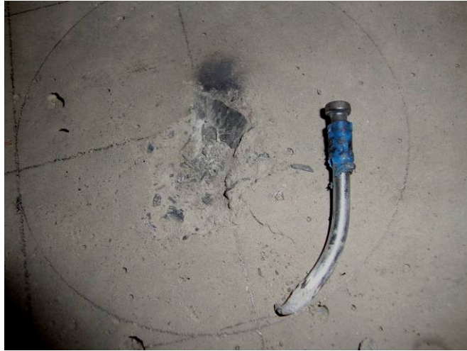
Figura 3-25 Pino não penetrou devido ao agregado graúdo
