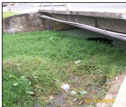
Figura 42: construção de pontes, sobre o canal principal, contribuindo para o estrangulamento do mesmo.
