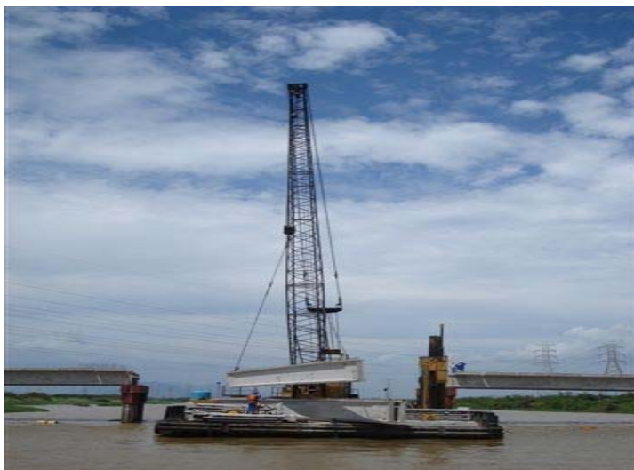
Figura 3.16 - Guincho utilizado no içamento de viga - Ponte sobre o rio Paraíba do Sul, São Fidélis, Rio de Janeiro, 2008 (cortesia Premag ® ).
