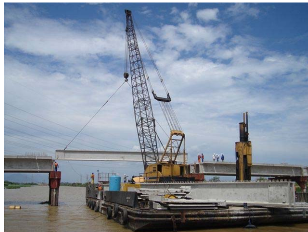
(c) Ponte sobre o canal São Fernando, Santa Cruz, Rio de Janeiro, RJ, montagem com guindaste sobre flutuante (cortesia da Premag®).
