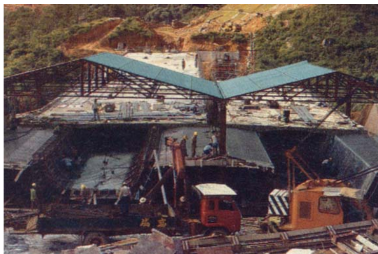
Figura 4.2 - Canteiro coberto para lançamento simultâneo de dois tabuleiros no anel viário de Tai Po, Hong Kong (ENGINEERING NEWS RECORD, 1984 apud WAINBERG, 2002).
