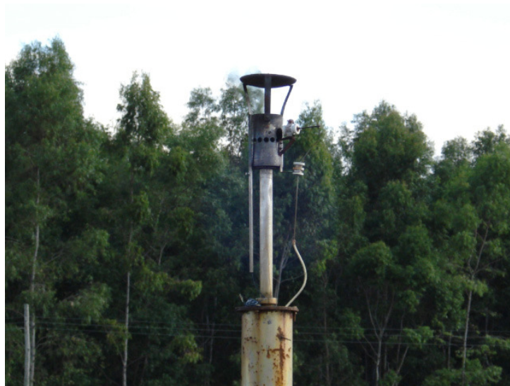
Figura 22: Flare (queimador) utilizado para queimar o biogás excedente.
