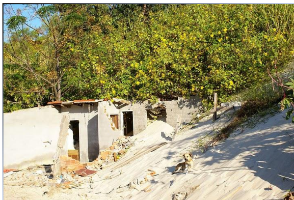
Figura 24 – Edificação destruída pela ação das dunas móveis na Vila Arvoredo. Fonte: Paulo Roberto Witoslawski (2009).
