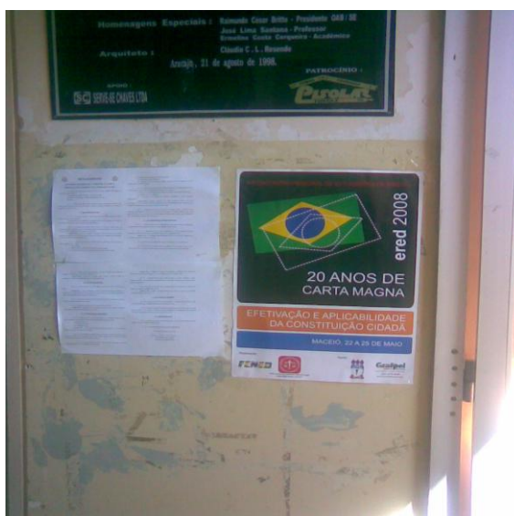
Figura 2.8 - parede depredada em razão de colagens de cartazes. UFS, São Cristóvão, 2009.
