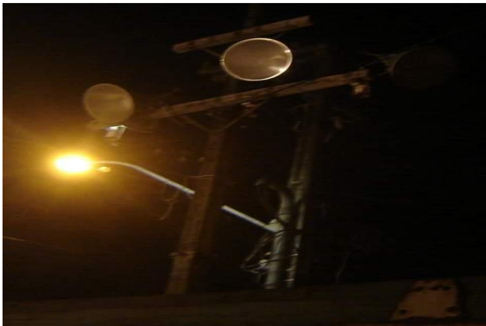
Figura 65 - Equipamento utilizado na iluminação da fachada do Convento de São Francisco. Ao fundo iluminação de trânsito.
