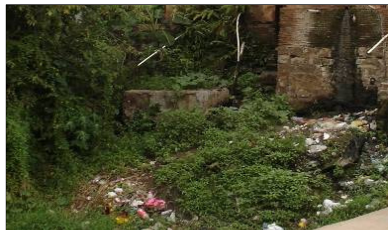
Acúmulo de lixo e despejo dos efluentes domésticos através de canos expostos, nas proximidades da barragem local. Fonte: Ícaro Maia, 2008.
