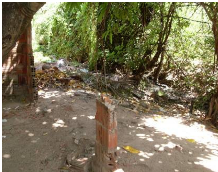
FOTO 7 – Maranguape (CE). Muros residenciais destruídos por enchentes.
