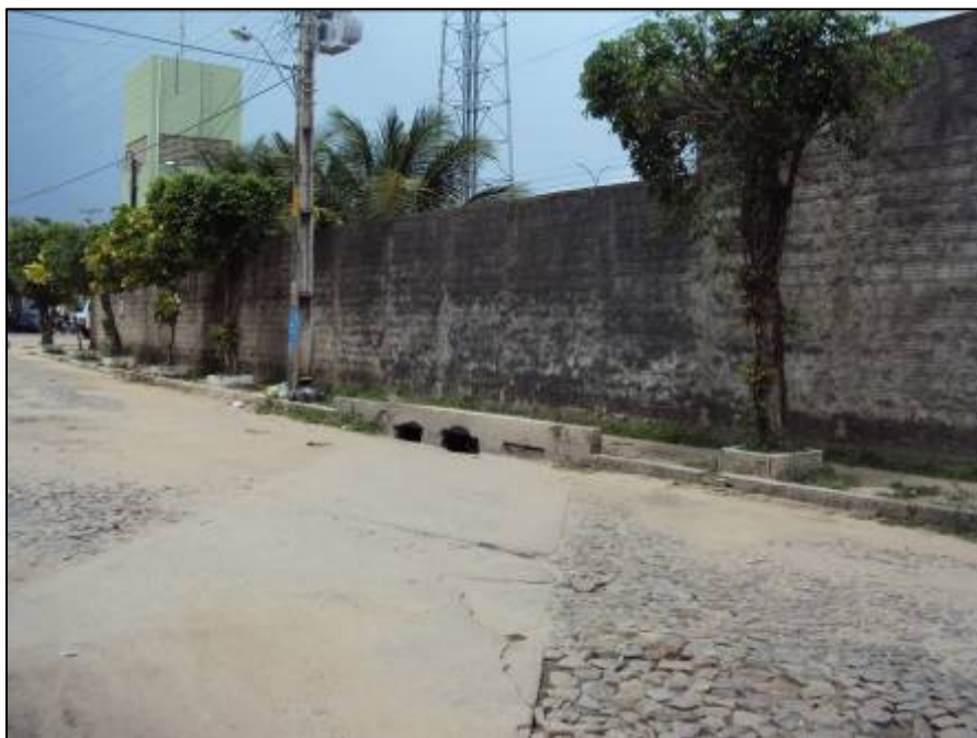
Um exemplo das canalizações subterrâneas dos riachos que recortam a cidade. Observar a integração com a rede de coleta pluvial. Fonte: Ícaro Maia, 2009.
