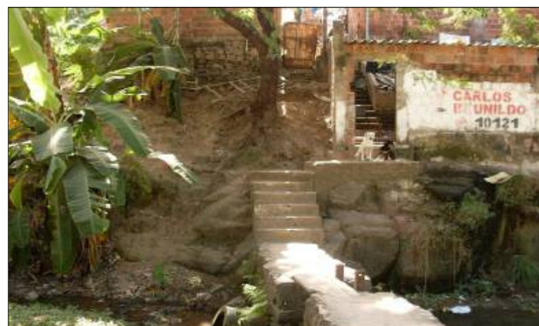
Pequeno barramento no riacho do Escorrego. Observar a declividade da margem e a presença de bananeiras. Fonte: Ícaro Maia, 2009.
