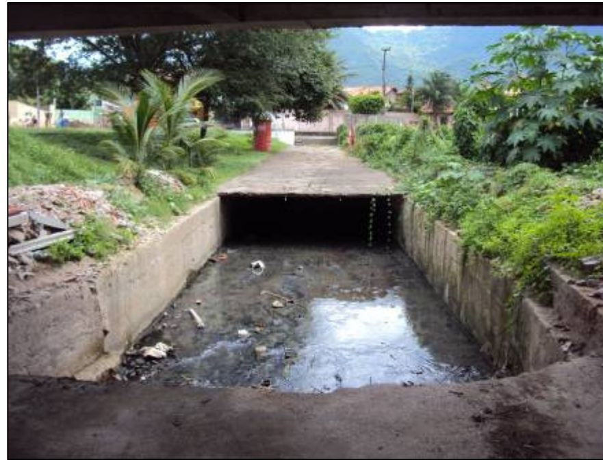
Trecho com abertura na canalização do riacho Barbante. Observar a cor da água e a presença de musgos. Fonte: Ícaro Maia, 2010.
