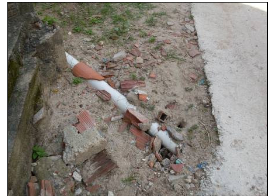
Exposição de encanamentos que direcionam o despejo das "águas servidas" para os canais de concreto. Fonte: Ícaro Maia, 2010.
