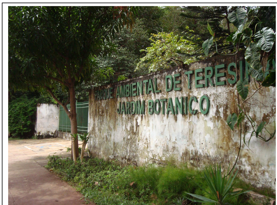
Figura 24 – Fachada do Parque Ambiental de Teresina, considerada pelos moradores como deteriorada.
