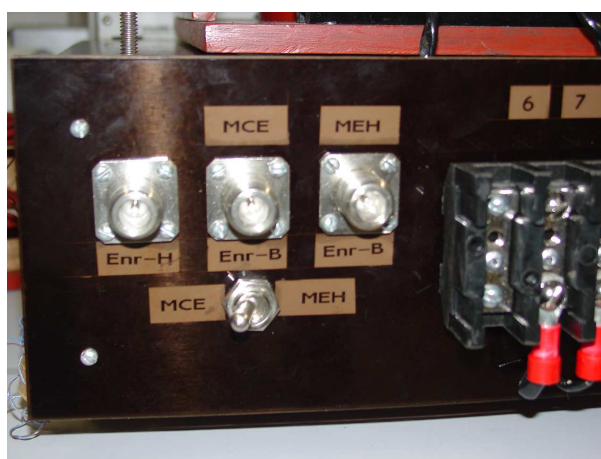
Figura 282: Conectores para os enrolamentos sensores do DCU.
