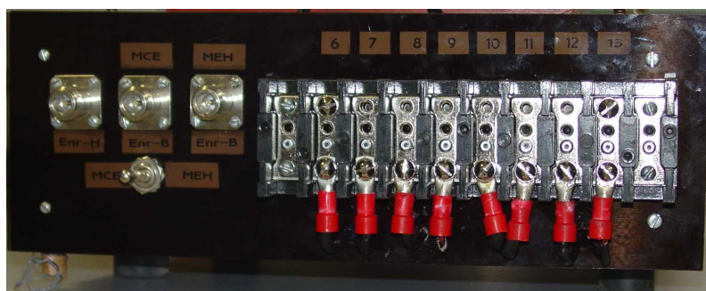
Figura 69: Painel de conexões do DCU.
