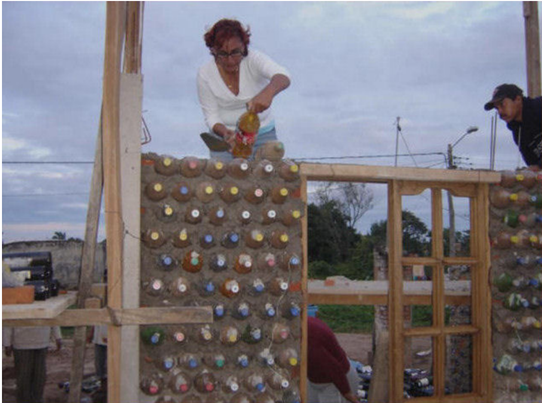
Figura 9: Exemplo de residência em construção utilizando garrafas PET em substituição aos tradicionais tijolos cerâmicos.
