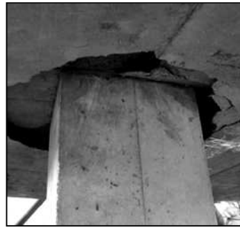
Vista inferior da laje após a ruptura
