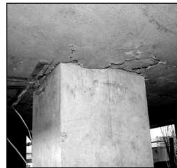
Vista inferior da laje após a ruptura
