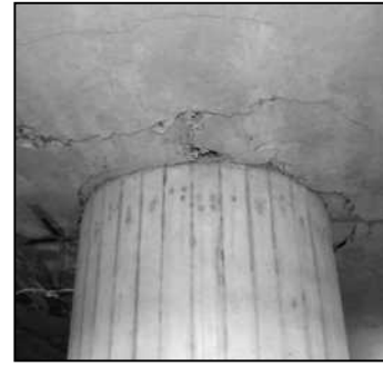
Vista inferior da laje após a ruptura
