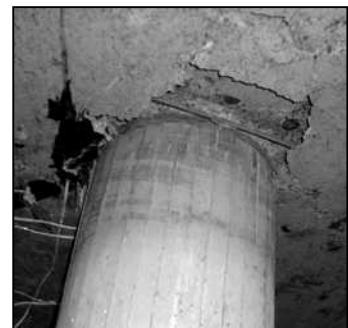
Vista inferior da laje após a ruptura
