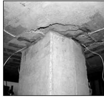
Vista inferior da laje após a ruptura
