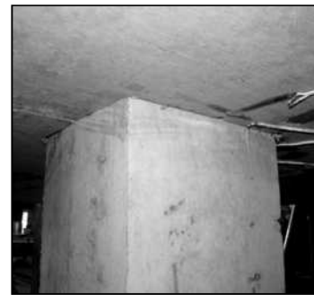
Vista inferior da laje após a ruptura
