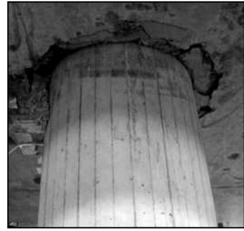
Vista inferior da laje após a ruptura
