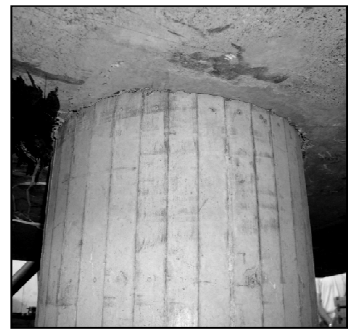
Vista inferior da laje após a ruptura
