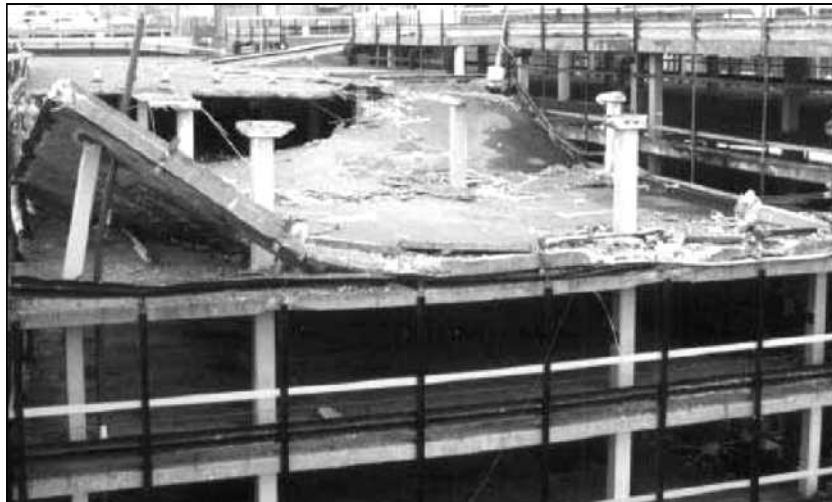
a) Colapso parcial do edifício Pipers Row Car Park
