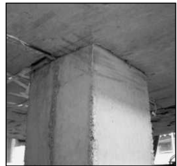
Vista inferior da laje após a ruptura
