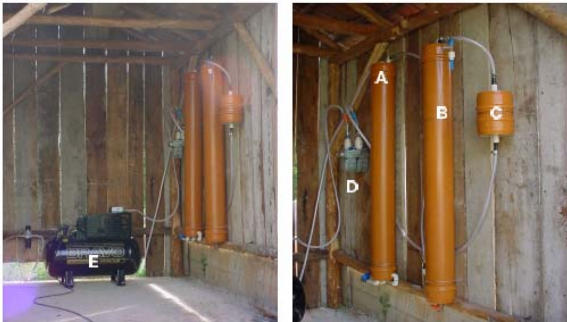
FIGURA 3.16 – Detalhe de unidade de purificação e compressão de biogás. A) coletor de umidade; B) Filtro de H_2S ; C) Espuma; D) Totalizador de gás; E) Compressor.
