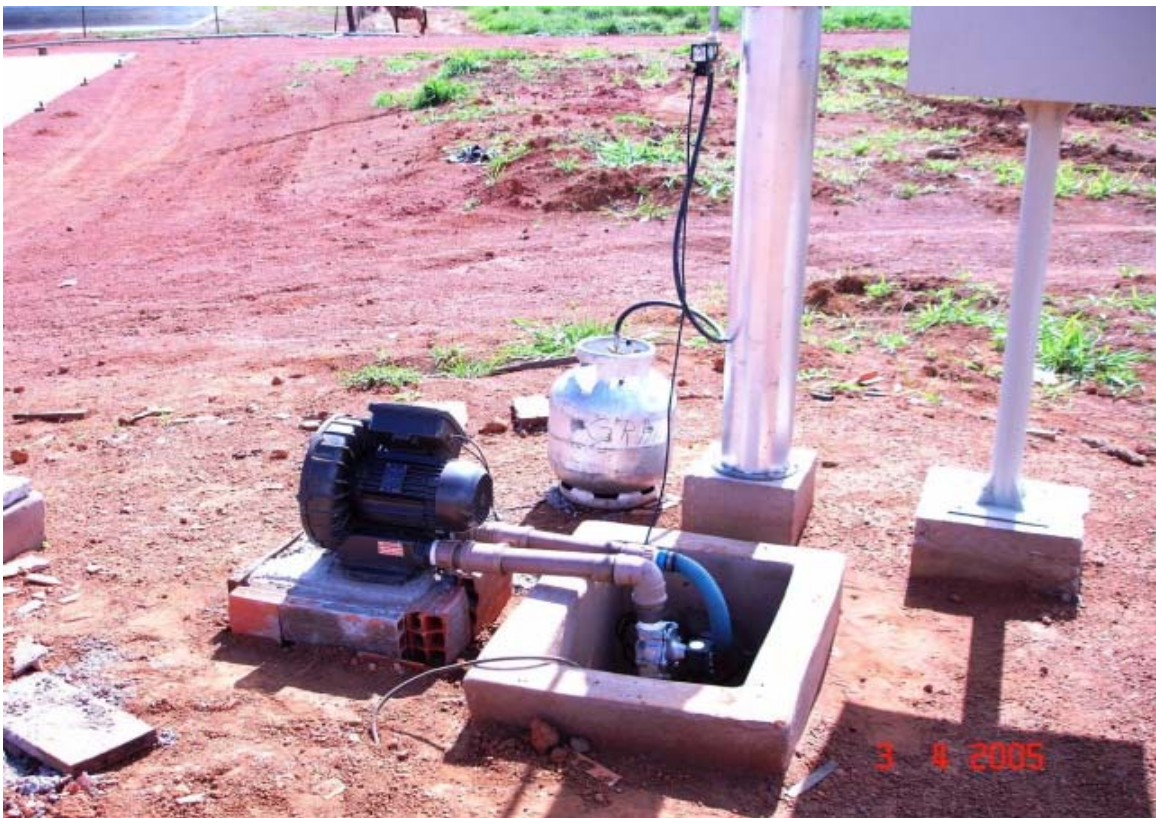
FIGURA 3.12 – Captação do biogás para queima.
