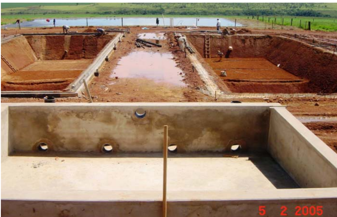
FIGURA 3.6 – Caixa de carga e reservatórios.
