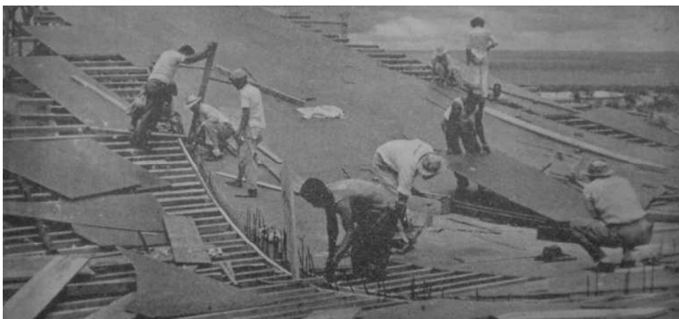
Figura 25 - Igreja Nossa Senhora de Fátima em construção. Fonte: Brasília nº 15, mar. 1958. p. 03.
