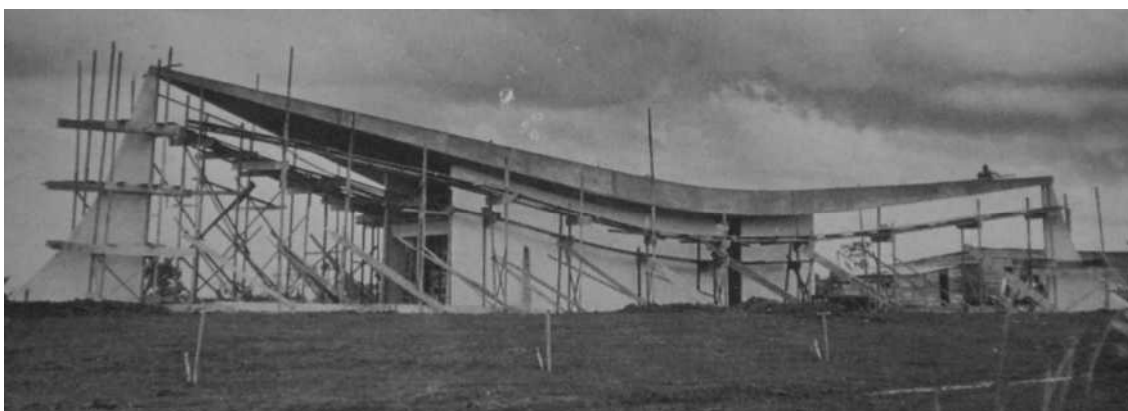
Figura 29 - Igreja Nossa Senhora de Fátima em construção. Fonte: Brasília nº 17, mai. 1958. p. 07.
