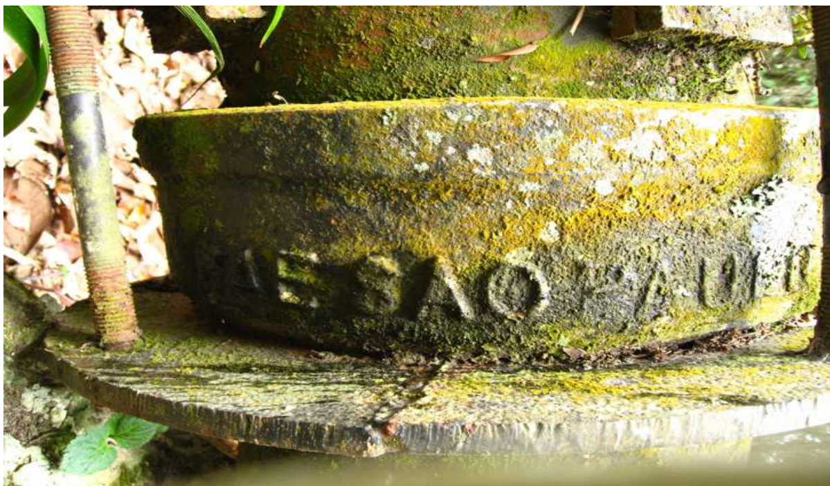
Foto de outubro de 2007, cano de 300 mm de saída da barragem gravado R.A.E. SP
