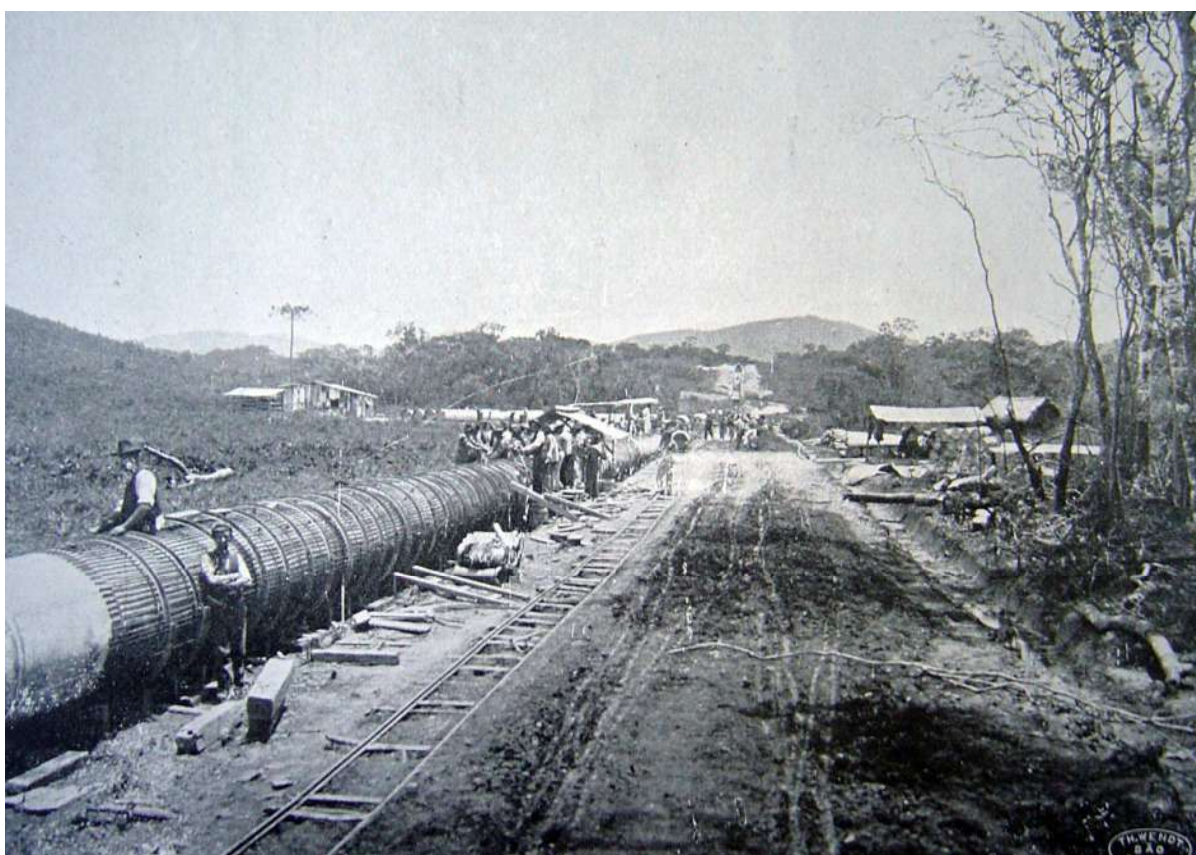
Sifão com 1 Km de extensão da adutora do Cabuçu. In Relatório da R.A.E. de 1906.
