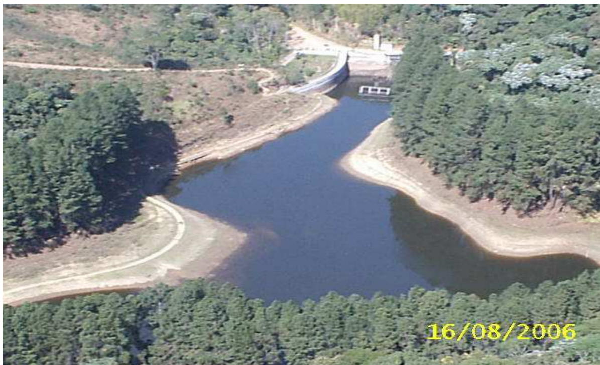
Foto, acervo S.A.A.E. Guarulhos. Vista aérea do interior do reservatório, à esquerda a barragem, totalmente recuperada.
