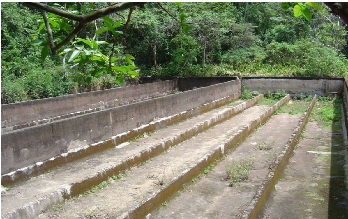
Foto de outubro de 2006, do clarificador do Barrocada
