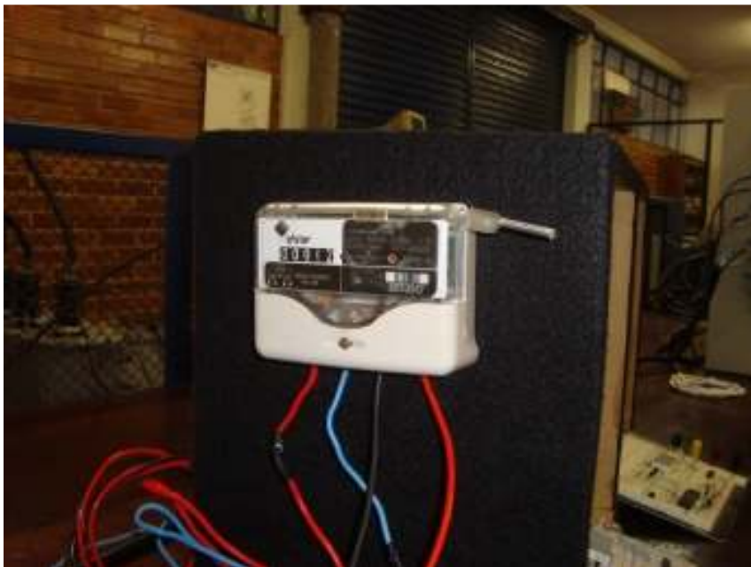
Fig. B-7 – Medidor monofásico do tipo eletrônico.
