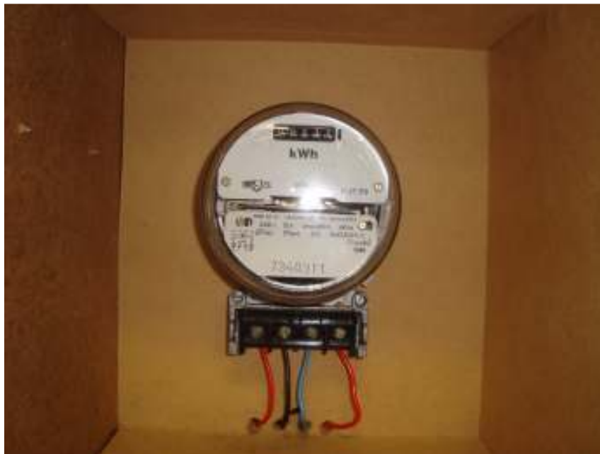
Fig. B-5 – Medidor monofásico do tipo eletromecânico.
