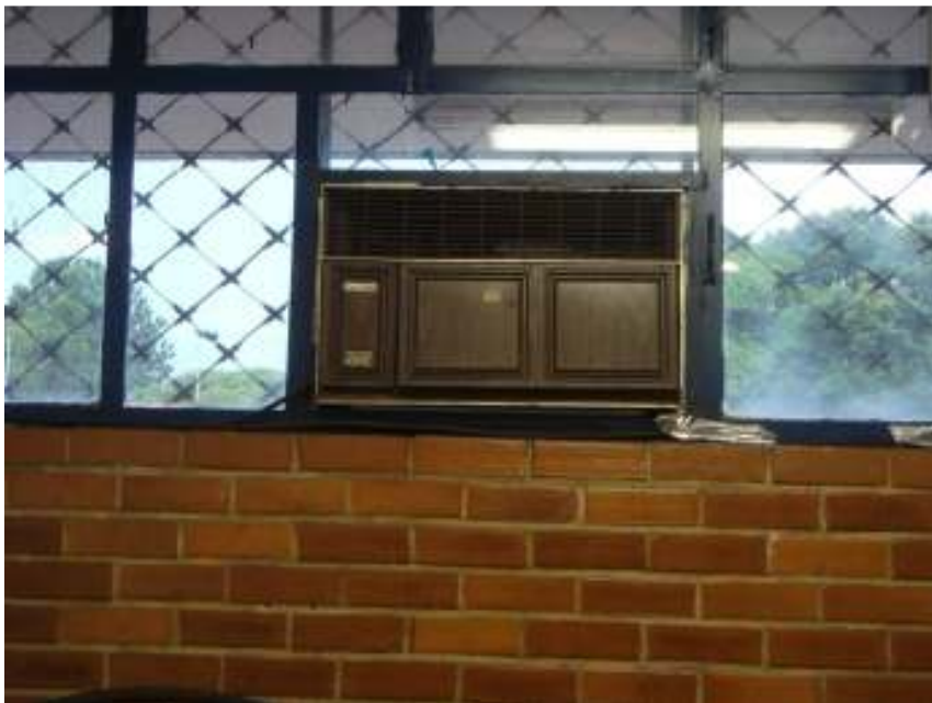
Fig. B-17 – Ar condicionado.
