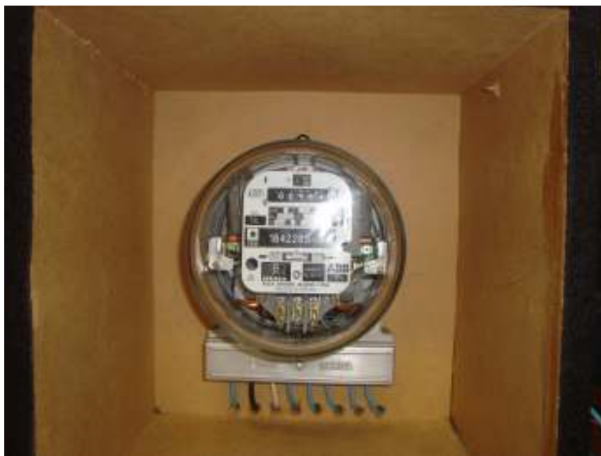
Fig. B-6 – Medidor trifásico do tipo eletromecânico.
