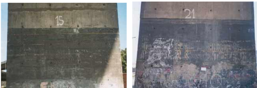
Figuras (26 e 27) Pilastra apagada. Foto de Leonardo Guelman
