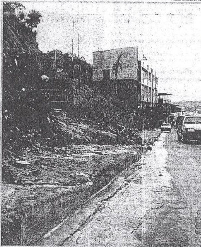
Dom Bosco: risco de novos deslizamentos em escadaria precepsa, Defesa Civil e moradores
