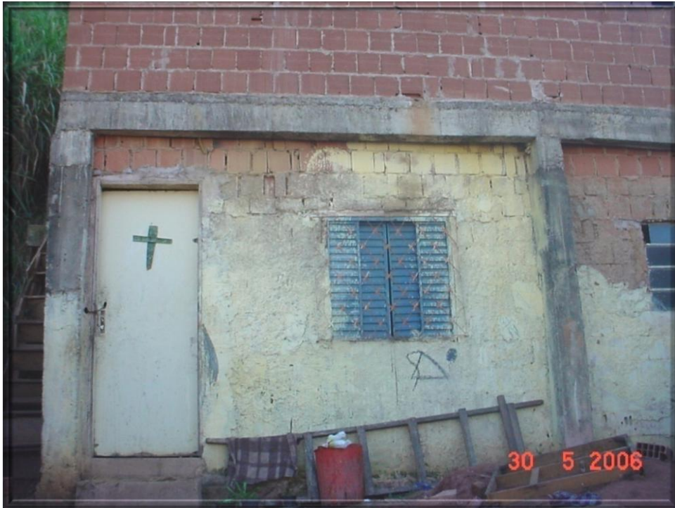
Foto 11: Moradia de Maria Isabel, demolida pela Defesa Civil em 2008. Fonte: Defesa Civil de Juiz de Fora - MG. 30 de Maio 2006.
