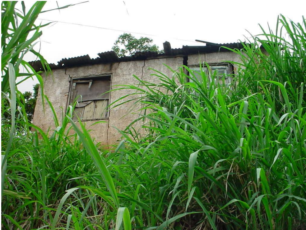
Foto 12: Moradia de Fátima, demolida em 2003. Fonte: Defesa Civil de Juiz de Fora – MG. Jan 2003.
