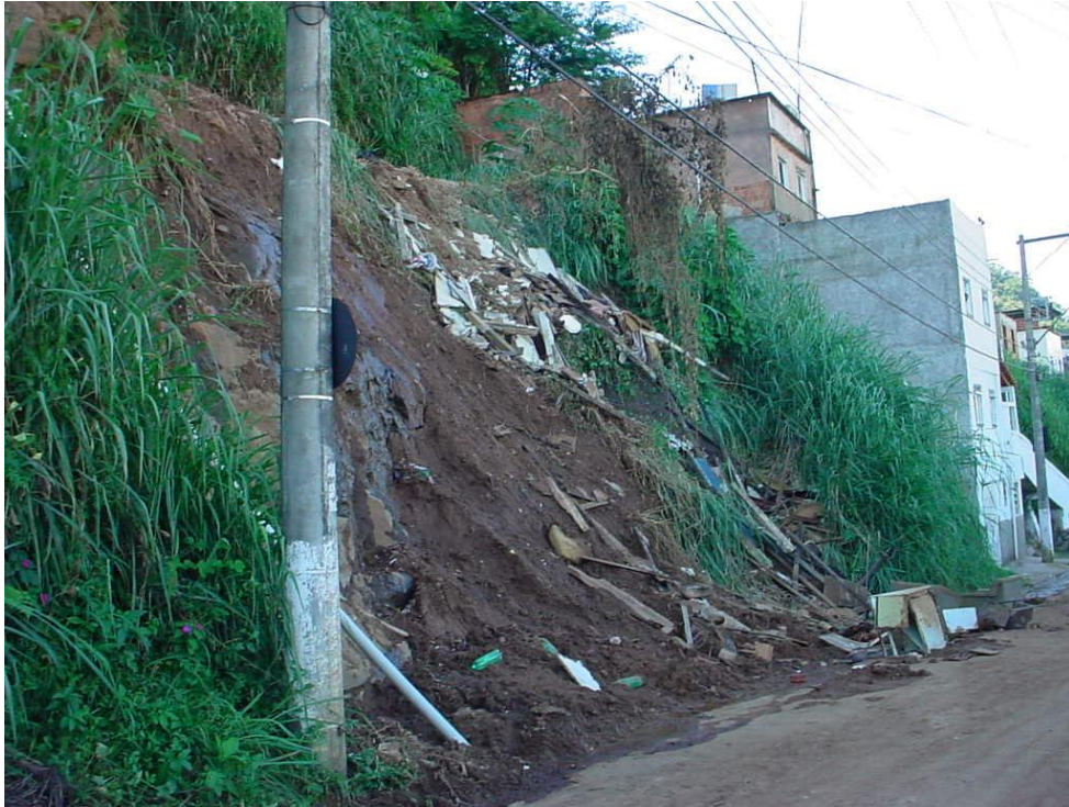
Foto 6: Um dos deslizamento de terra que afetou a rua Monsenhor Gustavo Freire. Presença de material no barranco como lixo e madeiras. Fonte: Defesa Civil de Juiz de Fora – MG. Jan 2003.
