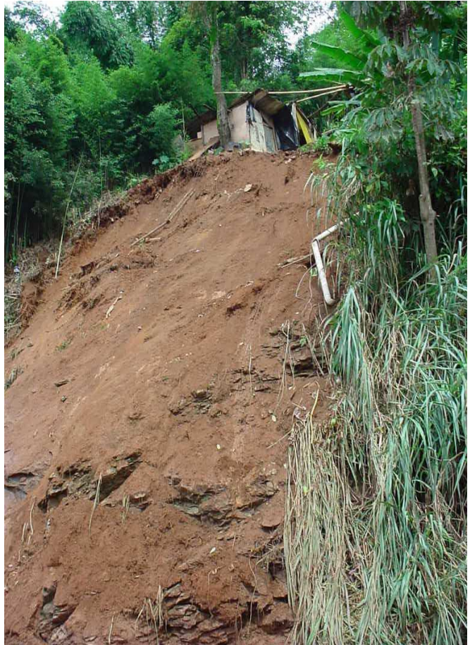
Foto 5: Deslizamento de Terra. Na beirada do barranco presença de habitação subnormal. Fonte: Defesa Civil de Juiz de Fora – MG. Jan 2003.
