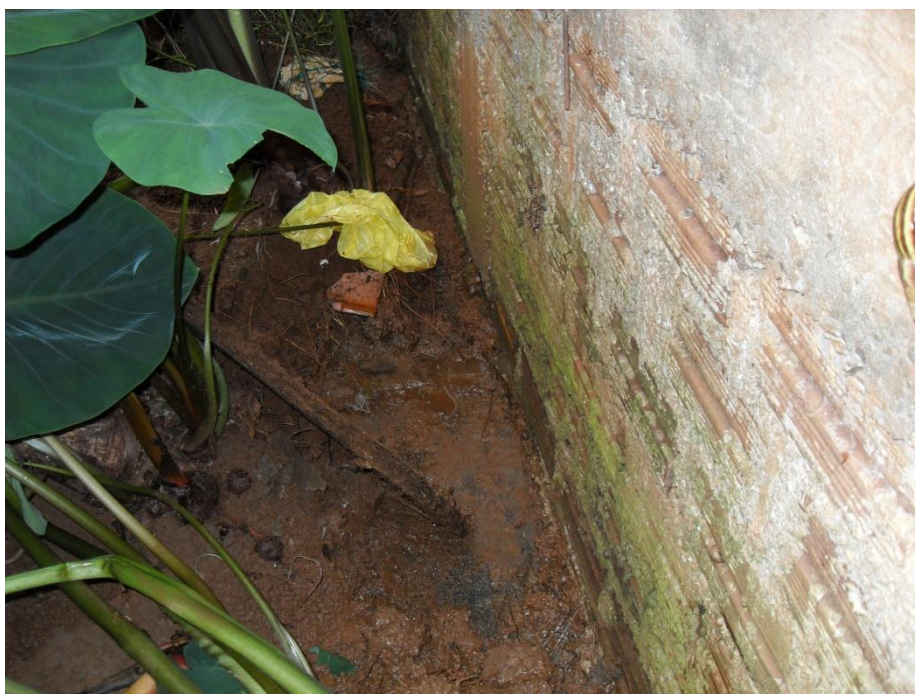
FIGURA 17: PRESENCIA DE UMIDADE NA PARTE EXTERNA DO MURO DE UMA RESIDENCIA NA RUA PION. FUMIE TANQUE NO RESIDENCIAL TARUMA
