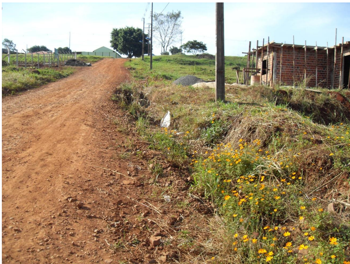
FIGURA 9: EROSÃO NA RUA CARLOS MAURÍCIO DUARTE NO RESIDENCIAL TARUMA Fonte: A Autora, 2010
