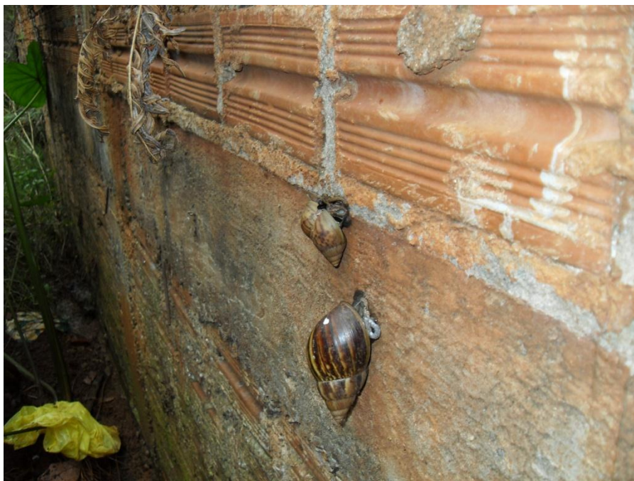
Figura 18: PRESENÇA DE CARAMUJOS COMPROVANDO A PRESENÇA DE UMIDADE NA RUA FUMIE TANQUE NO RESIDENCIAL TARUMA
