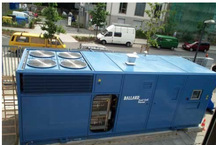
Figura 1.2 - CaC de 250kW instalada em Berlim, Alemanha, em 2000.
