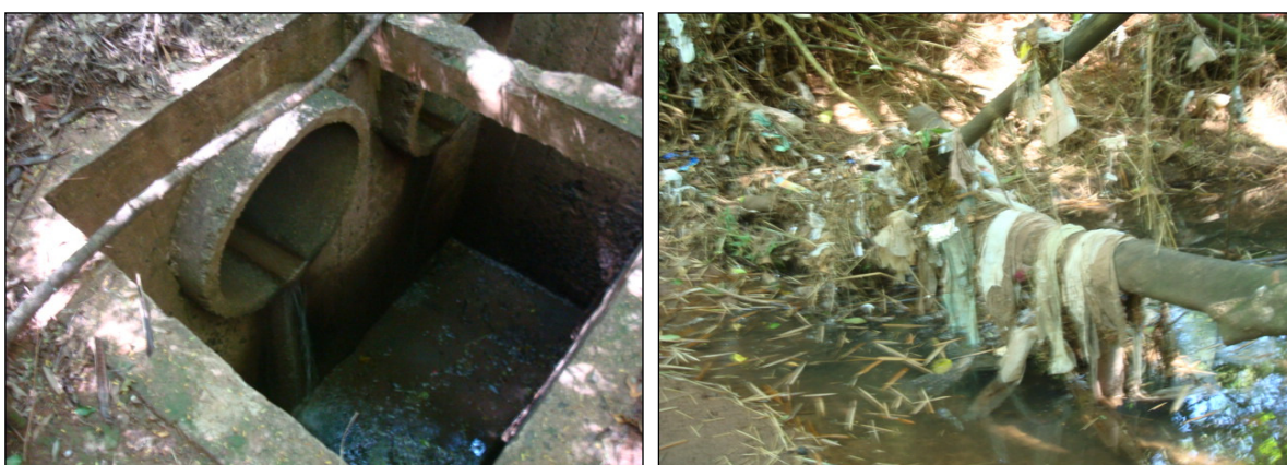
Figura 11: Galeria de águas pluviais e canal de drenagem com presença de lixo, no interior do Módulo Mandhuy.
