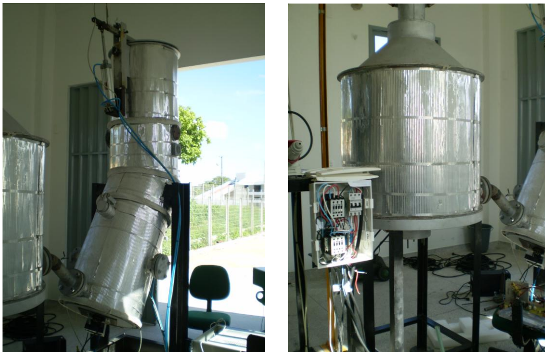
Figura 2.7 – Reatores primário e secundário da planta de tratamento.
