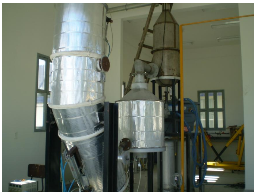
Figura 2.8 –Planta de tratamento de resíduos.
