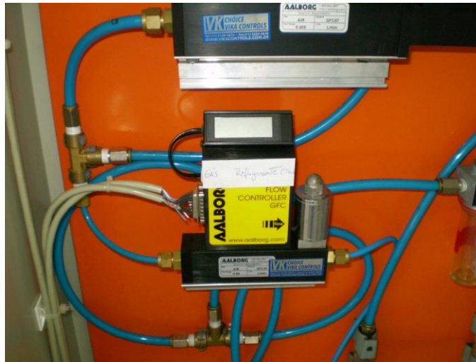
Figura 3.13 – Válvula de controle do gás refrigerante – controlador de fluxo mássico.
