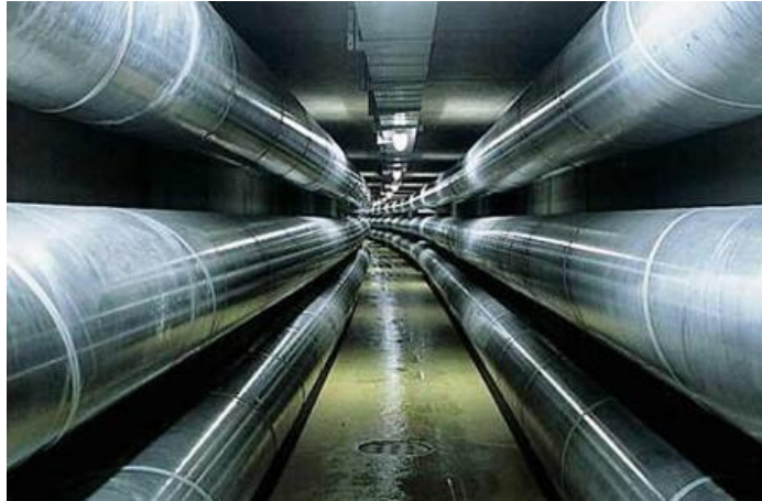
Figura 26 – Linhas de transmissão “gas-insuled”
