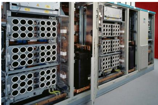
Figura 25 – Link de média tensão “Back to back”
