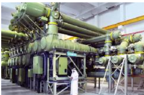
Figura 24 – Subestação com disjuntor isolado a gás
