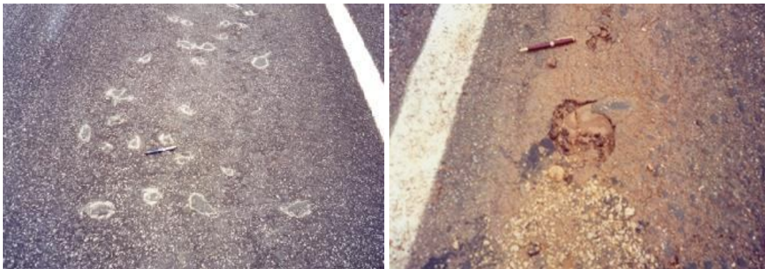
Figura 2.47: Revestimento em TSS, aparecendo no revestimento o seixo rolado da base. E como consequência o surgimento de panelas (CHAVES et al. , 2004).
