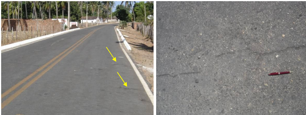
Figura 3.17: Trincas de retração transversais à rodovia ou pequenos trincamentos localizados (Fotos do autor).
