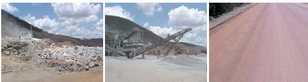
Figura 2.42: Desmonte e produção da brita na obra e aspecto da superfície de uma base a ser imprimada (CHAVES et al. , 2004).
