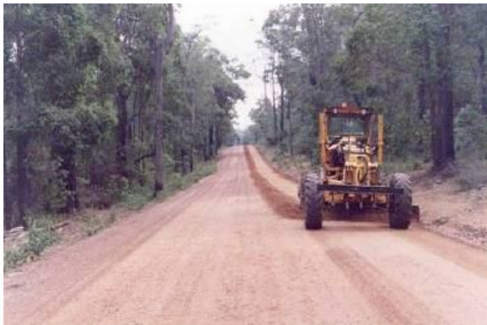
Figura 2.16: Manutenção periódica com serviço de patrolagem em estradas de terra da Nova Zelândia (Henning et al , 2008).
