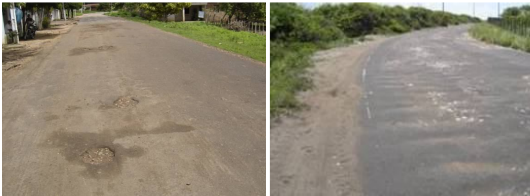
Figura 3.16: Panelas e desgaste provavelmente por problemas de dosagem da mistura asfáltica (Fotos do autor).
