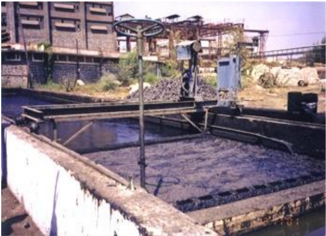
Figura 4 – Separador de água e óleo – tipo API
