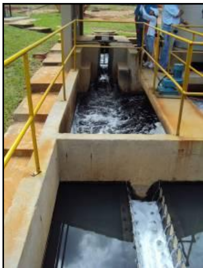
Figura 5.29.: Floculador da ETE.
