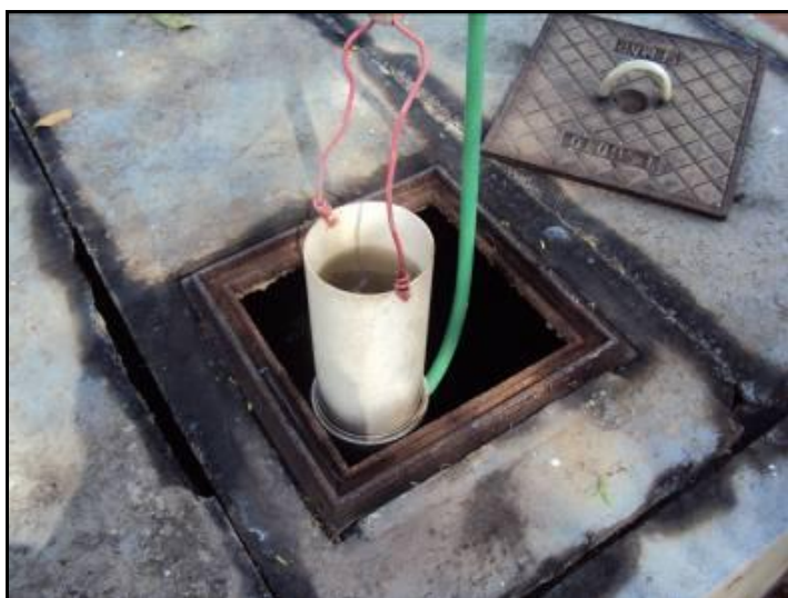
Figura 5.27.: Entrada do esgoto bruto à estação de tratamento.
