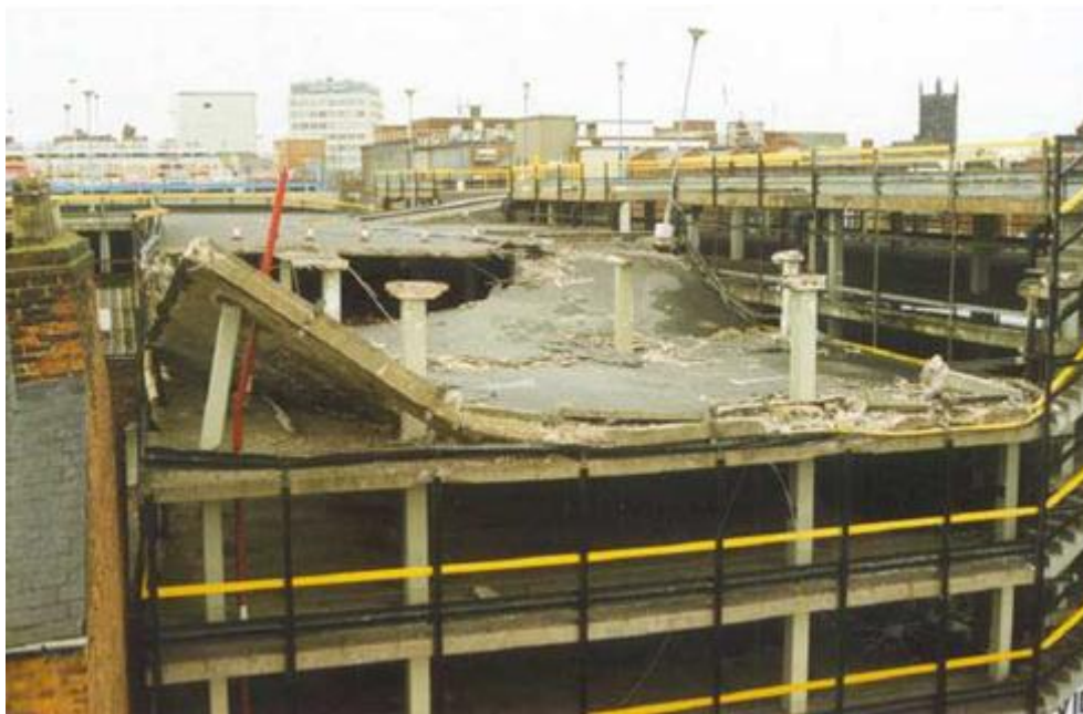
Figura 1.1 – Colapso parcial do edifício Pipers Row Car Park , Wolverhampton – Wood (1997).
