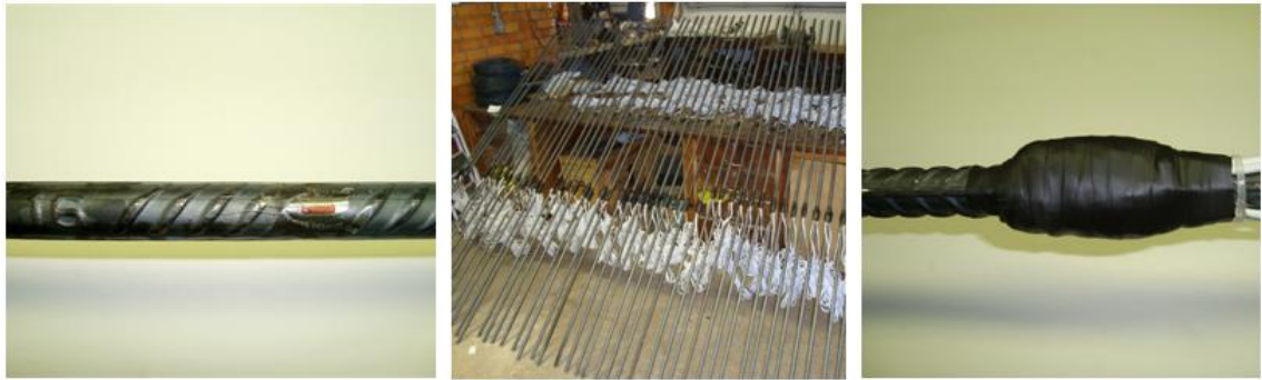
(a) Extensômetro colado em barra previamente preparada (b) Disposição das barra após o preparo (c) Proteção final da instrumentação
