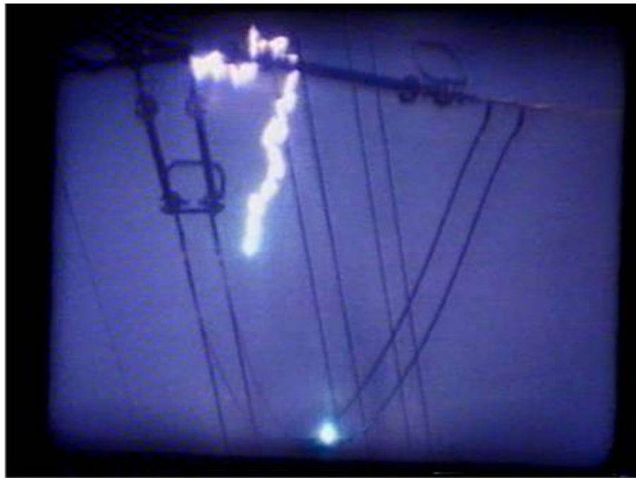
Figura 3.3: Arco Secundário iniciado por uma ponte no espaço aéreo
