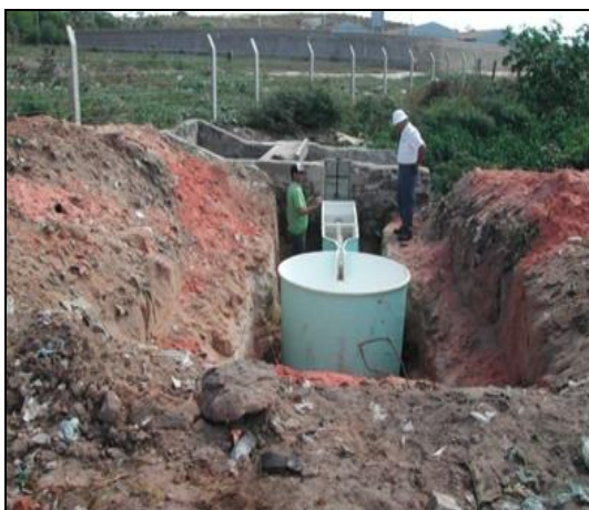
Figura 9A: Tanque de mistura para líquidos efluentes.
