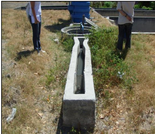
Figura 16- Medidor de vazão.
