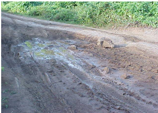
Imagem 34: Via local em estado precário de conservação; Fonte: Elabore (2008)
