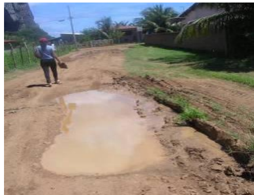
Imagem 36: Via local sem calçamento adequado para o pedestre; Fonte: Elabore (2008).
