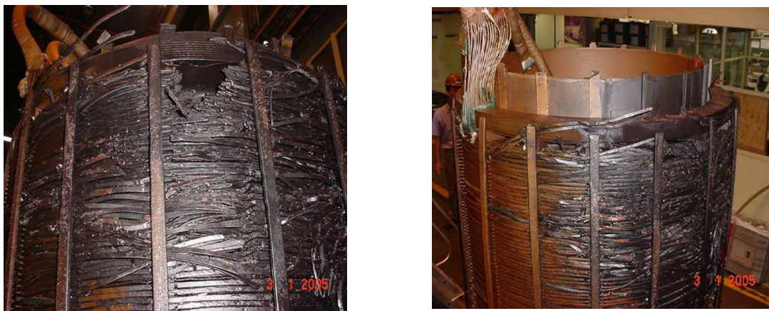
Figura 3. Falha em transformador elevador 13,8 kv - 70 MVA (Volume de Óleo: 25.000 L, Tipo de óleo: N – 10)
