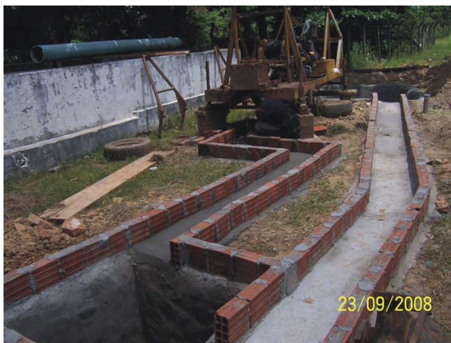
Figura 5.21 - Perfuração do poço de produção na EE Caixa d'Água, no primeiro plano observa-se o tanque para a lama e a calha para circulação.
