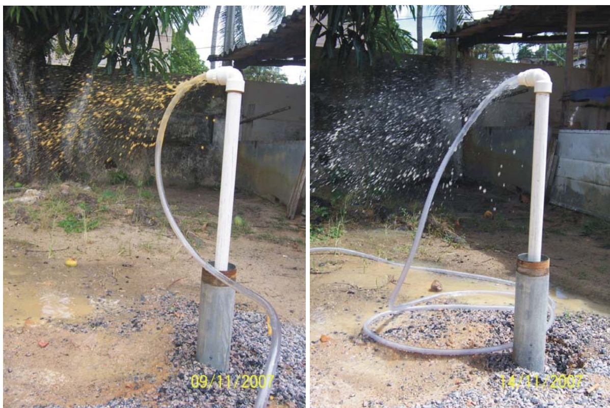
Figura 5.18 - Desobstrução dos poços de observação, injeção de ar por um compressor, em um primeiro momento e após alguns dias.
