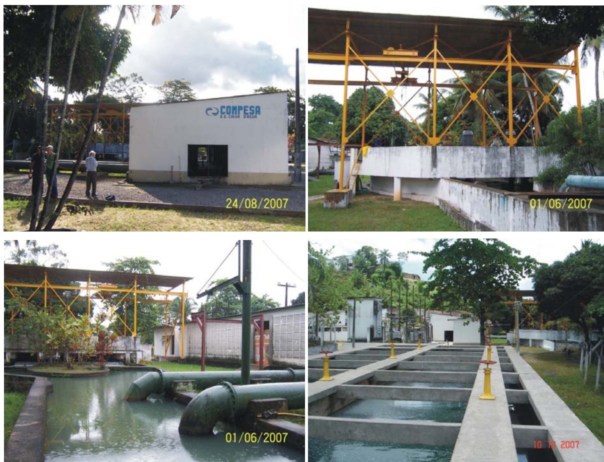
Figura 5.3 - Estação Elevatória de Caixa d'Água, bairro de Caixa d'Água, em Olinda, no limite com Recife.
