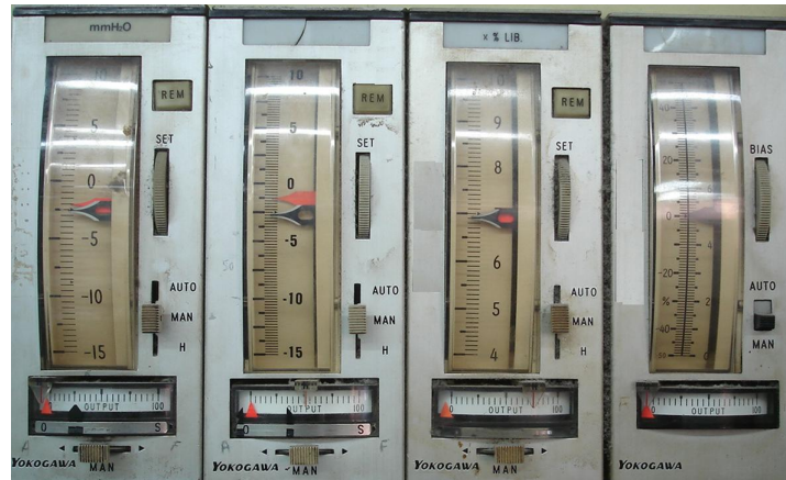
Figura 1.6: Ilustração dos controladores de processo no painel.
