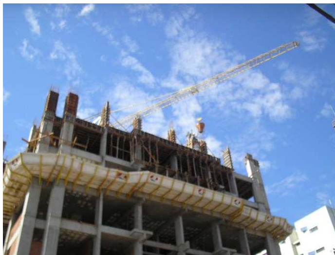
Figura 17 – Ajuda da grua para concretagem de pilares, que foi realizada com o sistema de caçamba para elevação de cargas.
