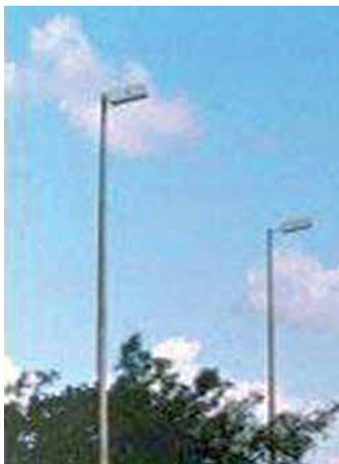
Figura 2.144 - Detalhe da Luminária do Eixo Rodoviário
