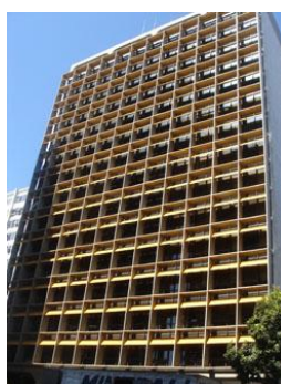
Figura 7.37 – Edifício pior classificado na apreciação da fachada
