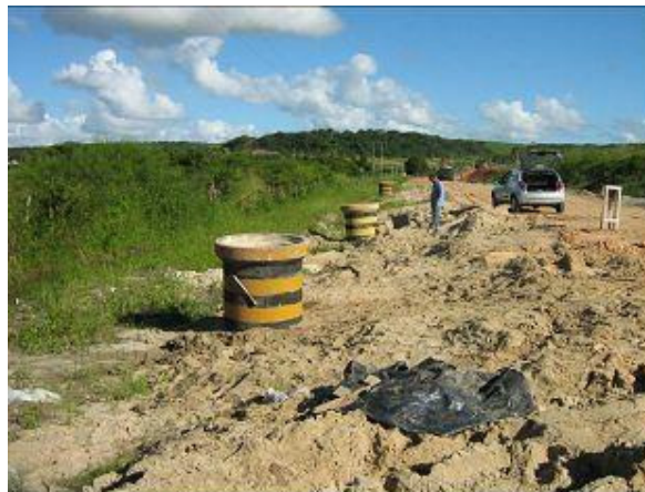
Foto 8 – Vista Geral de um subtrecho com os Instrumentos Instalados
