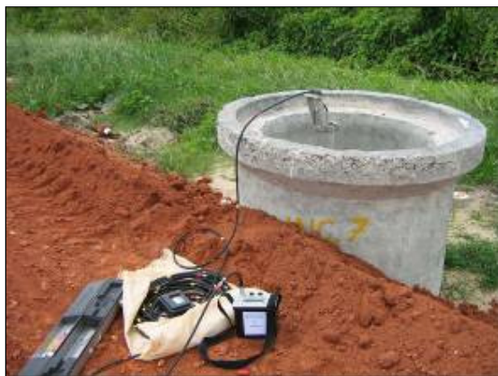
Foto 2 – Vista do equipamento de leitura dos Inclínômetros
