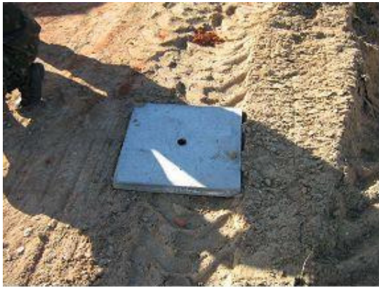
Foto 4 – Placa de Recalque
