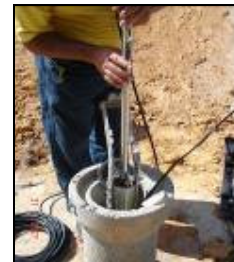
f) instalação inclinômetro
