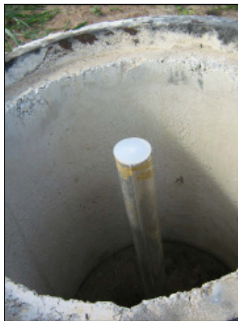
Foto 1 – Vista do tubo de inclinômetro instalado e protegido por manilha de concreto
