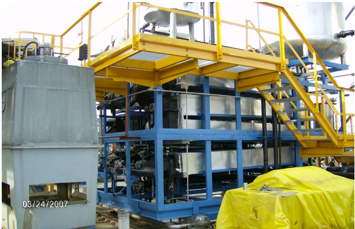
Figura 5.3 – Skid de condensação de vapores de hidrocarbonetos
