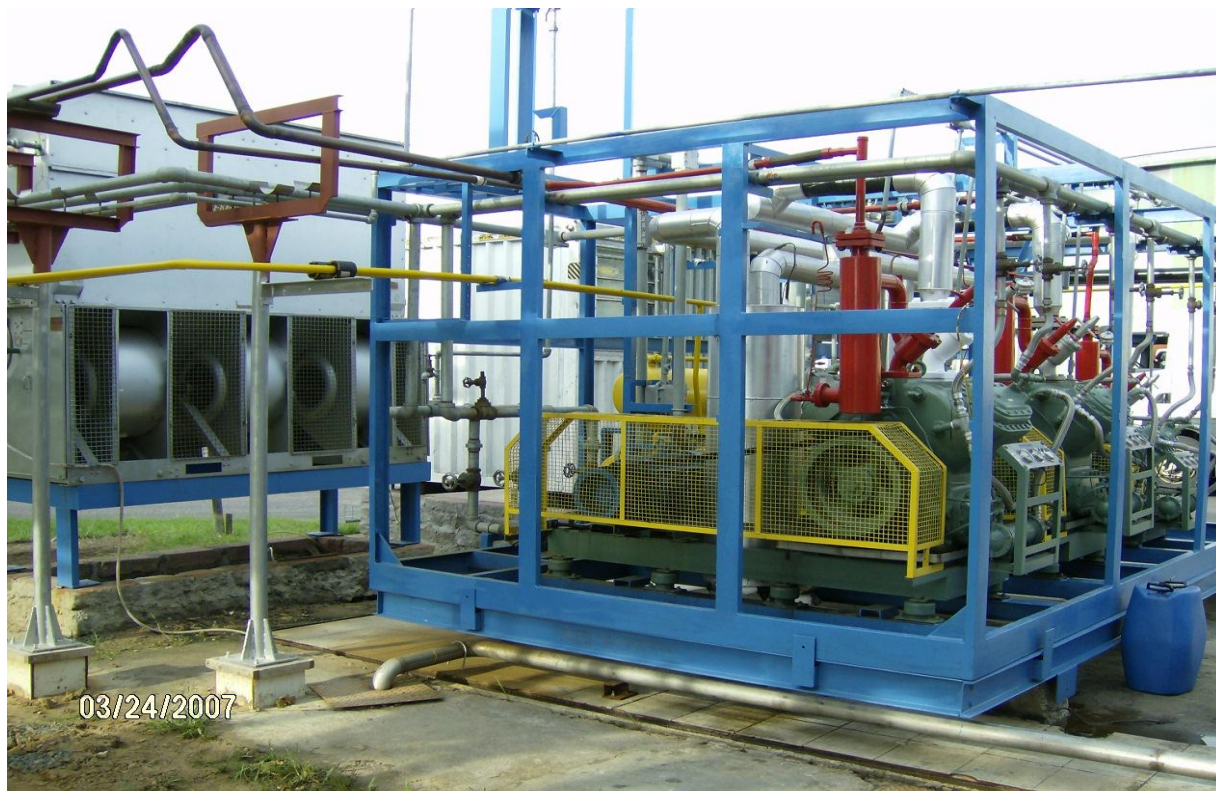
Figura 5.4 – Skid de refrigeração
