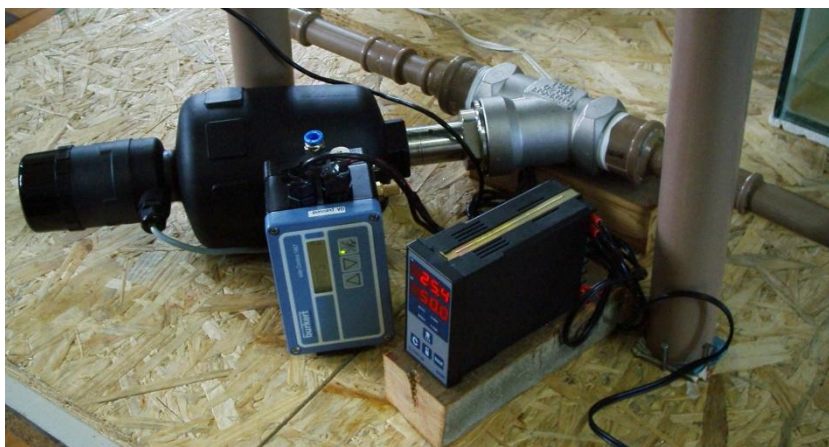
Figura 3.6 – Válvula atuada por ar comprimido e o controlador de processo
