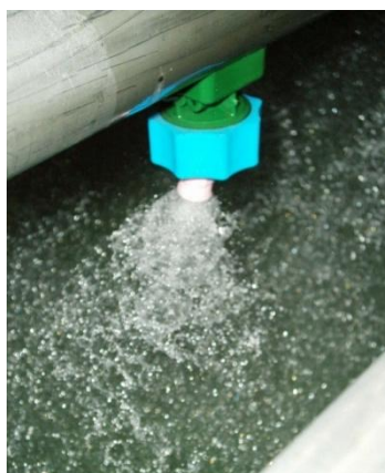
Figura 3.18 – Esguicho marca Bete montado em um túnel de pasteurização
