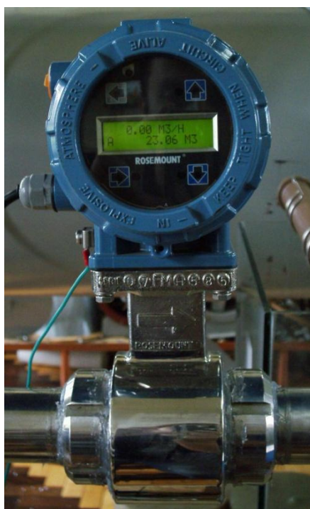
Figura 3.5 – Medidor de vazão instalado na tubulação dos esguichos
