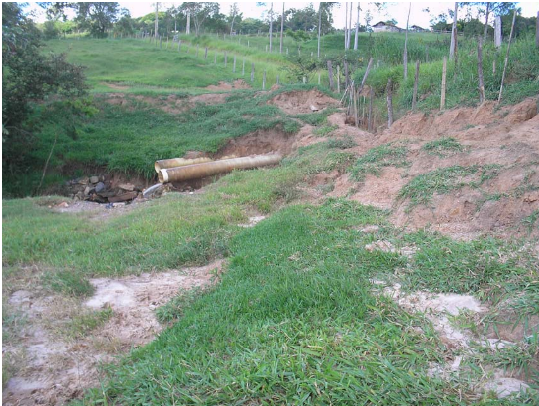
Figura 22 - Escoadouro danificado após tempestade (Foto: Mário M. Sakaguti Jr., 2009)
