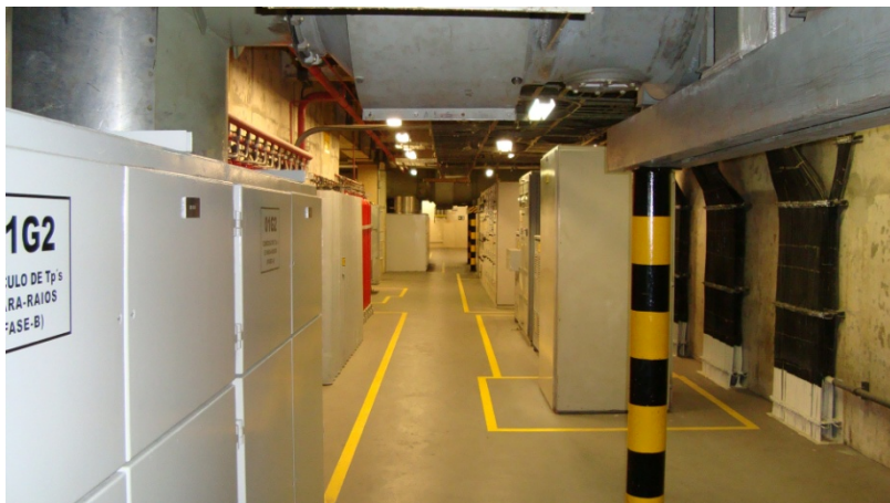
Figura 2.5 – Imagem do piso da Air Housing da PA IV.
