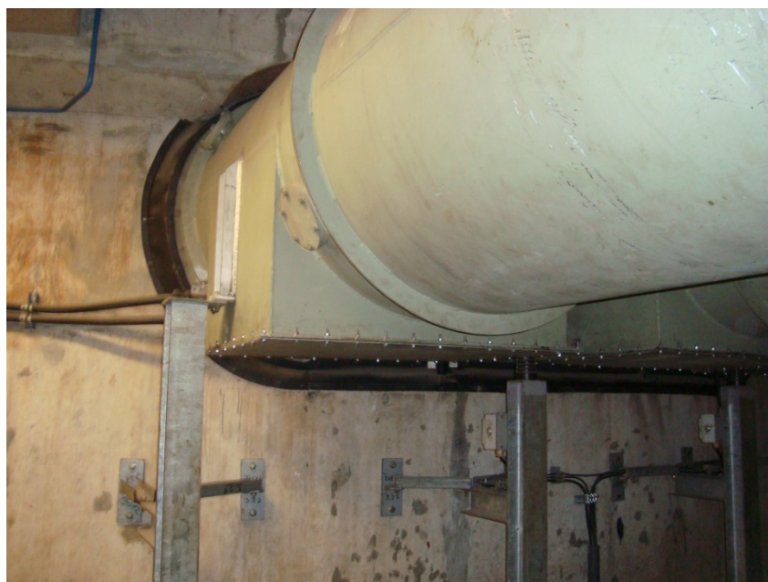
Figura 6.14 – Área de saída do barramento da Air Housing da unidade geradora 04G1: ambiente adverso para medições de nível de potência sonora.
