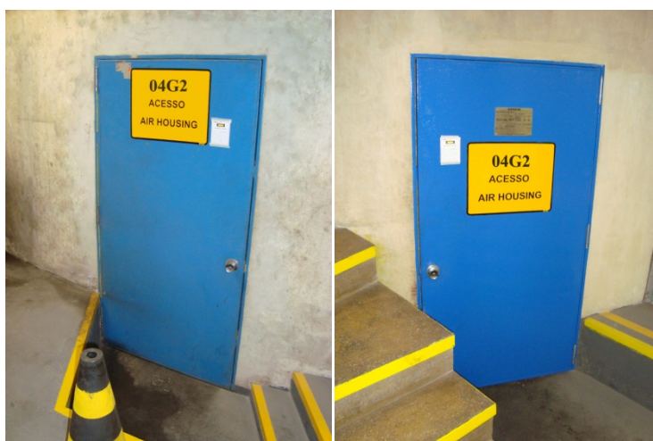
Figura 6.11 – Portas de acesso ao interior da Air Housing da unidade geradora 04G2, construídas diametralmente opostas.
