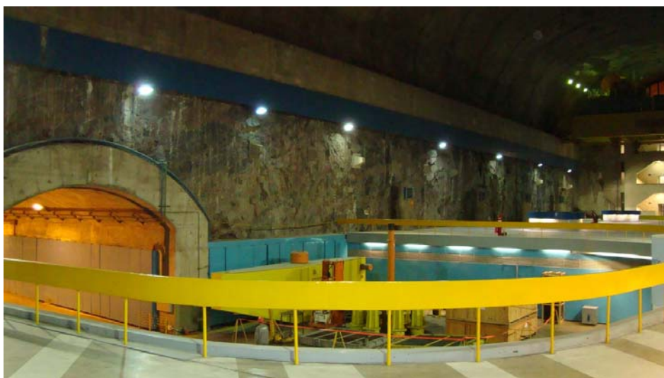
Figura 6.7 – Vista, a partir do piso do Gerador, da área do Hall de montagem do piso da Air Housing .
