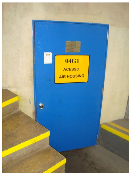
Figura 4.23 – Porta da Air Housing da unidade geradora 04G1.
