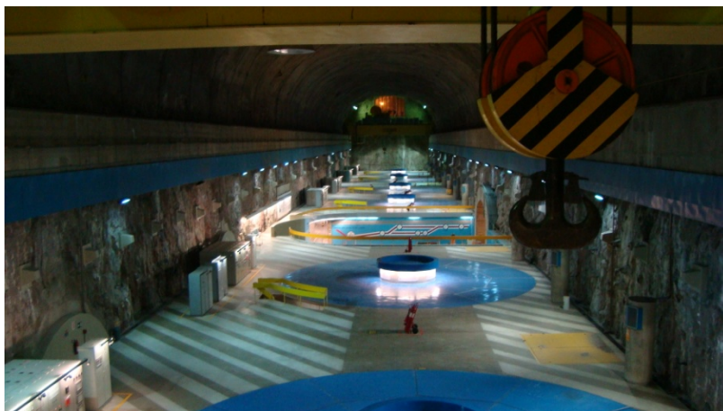
Figura 2.4 – Imagem do piso do gerador da PA IV.
