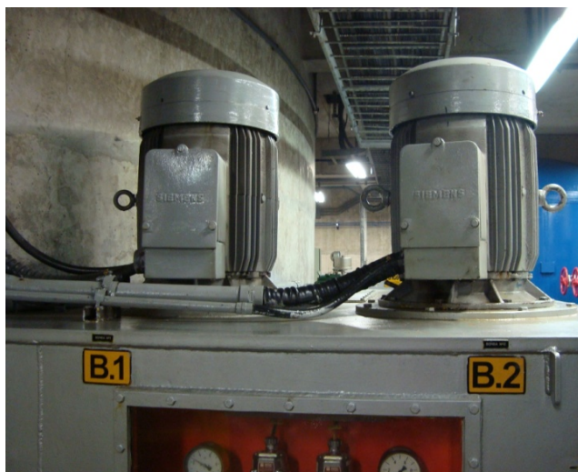
Figura 4.27 – Bombas do tanque de purificação de óleo dos mancais da unidade geradora 04G6.
