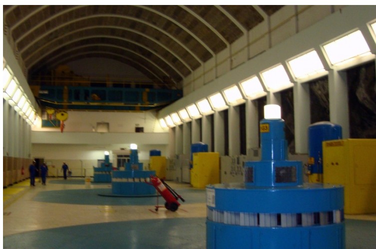
Figura 1.2 – Topo do gerador das unidades geradoras (01G1, 01G2 e 01G3) da usina PA I.
