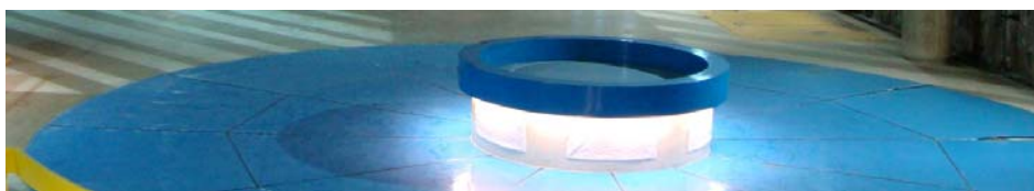
Figura 4.22 – Topo do gerador da unidade 04G1.
