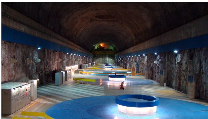
Figura 1.6 – Topo do gerador das unidades geradoras (04G1, 04G2, 04G3, 04G4, 04G5 e 04G6) da usina PA IV.
