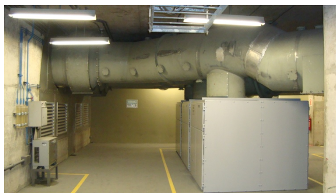
Figura 4.20 – Dutos de refrigeração da Air Housing da 04G6.
