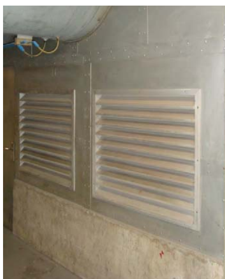
Figura 4.26 – Abertura do exaustor próximo à unidade geradora 04G2.
