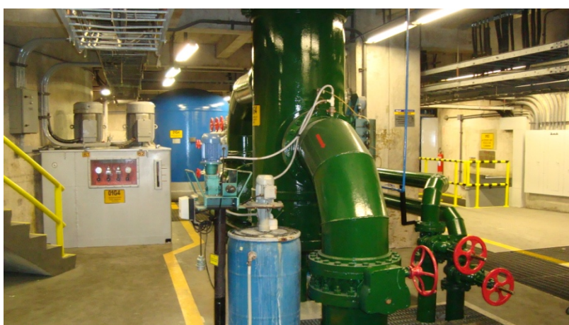
Figura 2.6 – Imagem do piso da turbina da PA IV.
