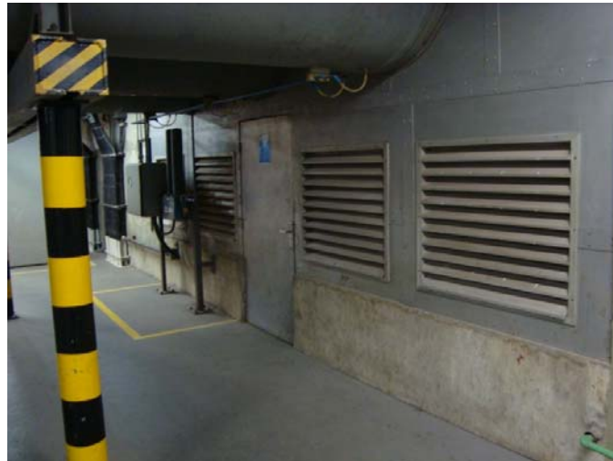
Figura 6.12 – Exaustores próximos à unidade geradora 04G2.
