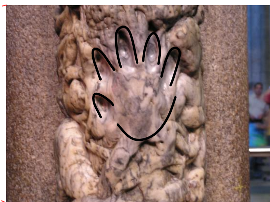
c) detalhe da região da coluna que sofreu o desgaste.
