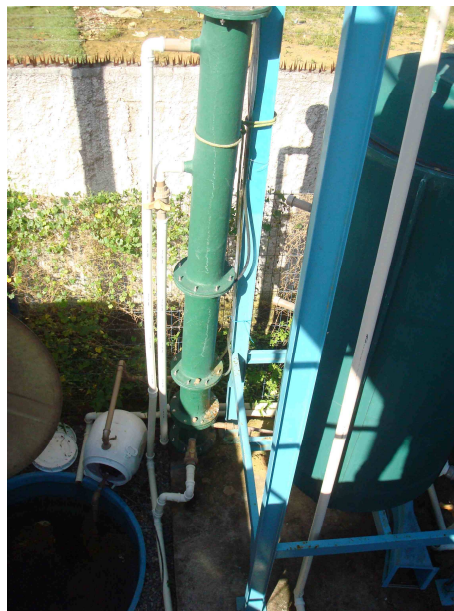
Figura 17 – Fotografia do filtro rápido e reservatório de lavagem (enterrado).
