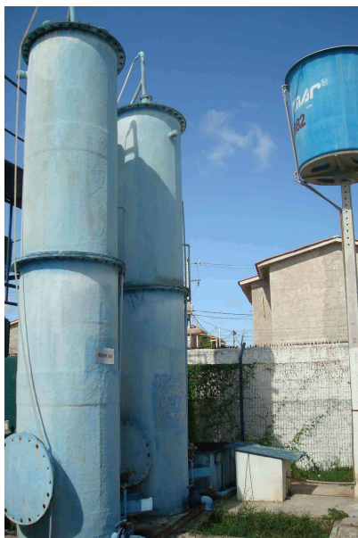
Figura 13 – Fotografia do reator UASB e leito de secagem ETE Mangueira (Março/2009)
