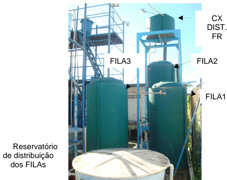
Figura 18 – Fotografia do reservatório de distribuição e FILAs instalados na Estação Experimental Mangueira Julho/2009
