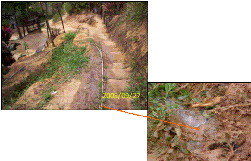
Figura II.14: Vazamento de Tubulações (Encostas da RM-Recife)
