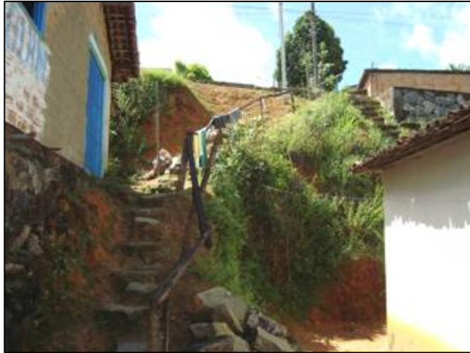
Figura VI.15: Talude de Solo Residual Maduro de Milonito (Vista Alegre / Jaboatão dos Guararapes)
