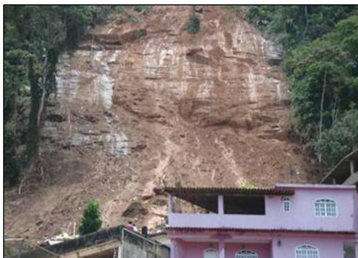
Figura II.22: Detalhe do Deslizamento no Morro da Carioca, em Angra dos Reis (Foto: http://g1.globo.com - acesso em 11/01/10)
