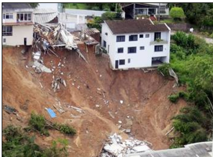
Figura II.25: Deslizamento em Santa Catarina (23/11/2008) (Foto da Internet)
