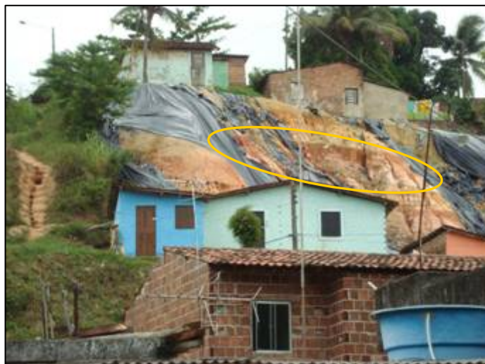
Figura V.2. Erosão no Talude de Sedimentos da Formação Barreiras de Planície Aluvial (Bairro dos Estados / Camaragibe)
