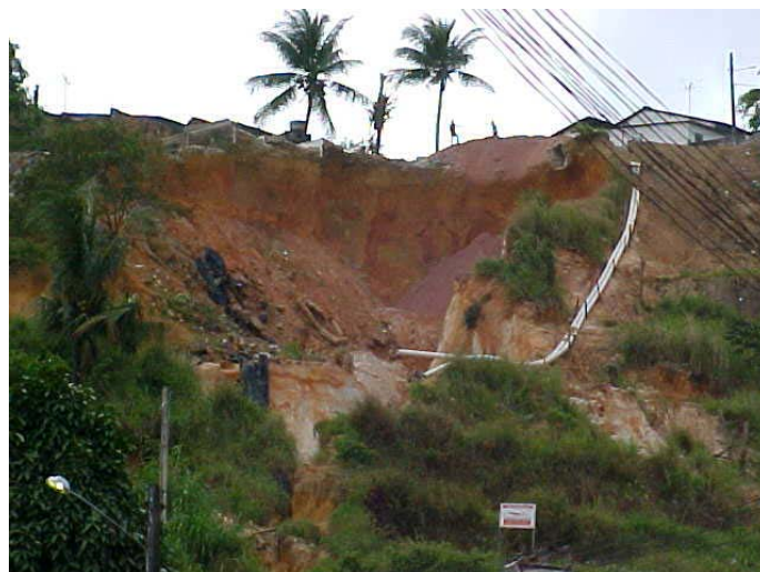
Figura II.3: Erosão na Rua Camanducaia, UR-02 / Ibura (Foto: ALHEIROS, 2006)
