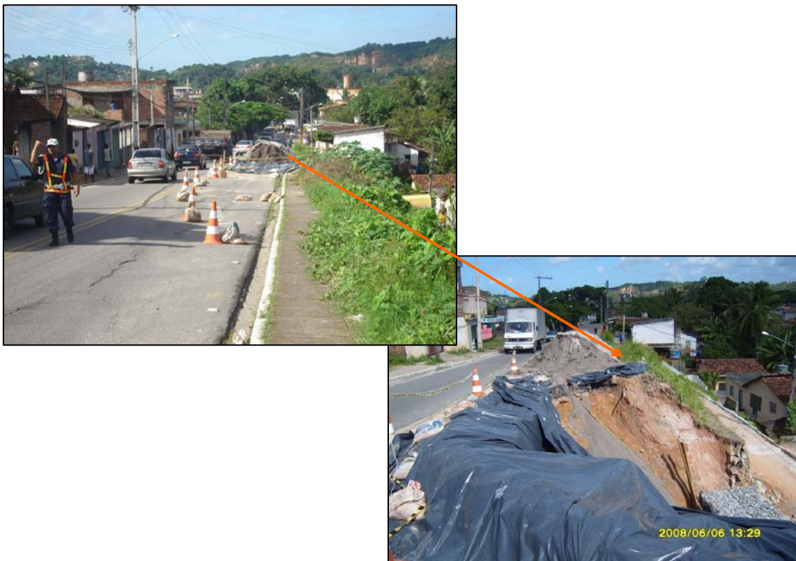
Figura II.8: Deslizamento na PE-27 / Camaragibe (Maio/2008)
