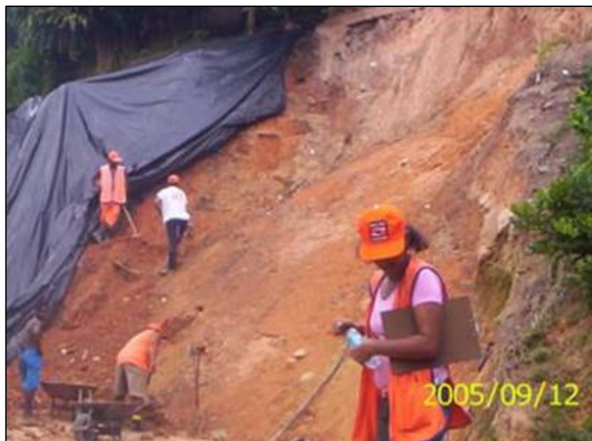
Figura II.9: Deslizamento em Camaragibe (2005)
