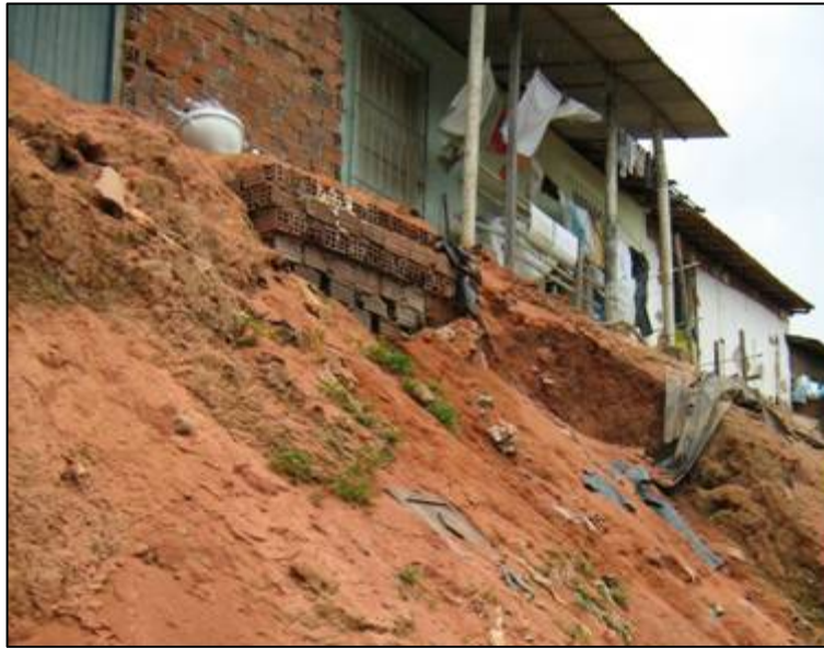
Figura II.13: Fossa na Borda do Talude (Encostas da RM-Recife)
