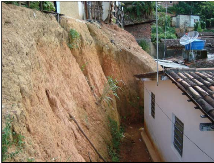
Figura II.11: Taludes Verticalizados e Sem Proteção Superficial (Encostas da RM-Recife)
