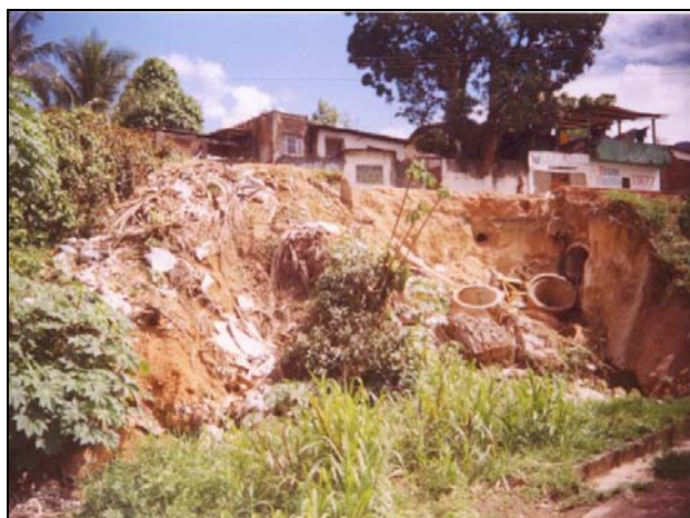
Figura II.4: Erosão em Área Urbana no Município de Camaragibe devido a Vazamento de Tubulação de Águas Servidas (Foto: BANDEIRA em 2002)
