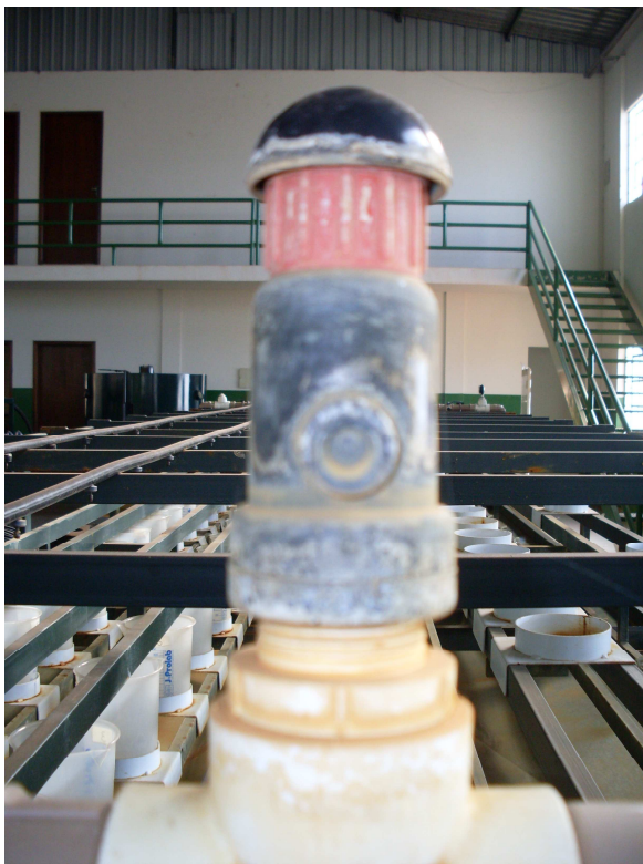
Figura 3 – Vista geral da válvula da saída de ar.
